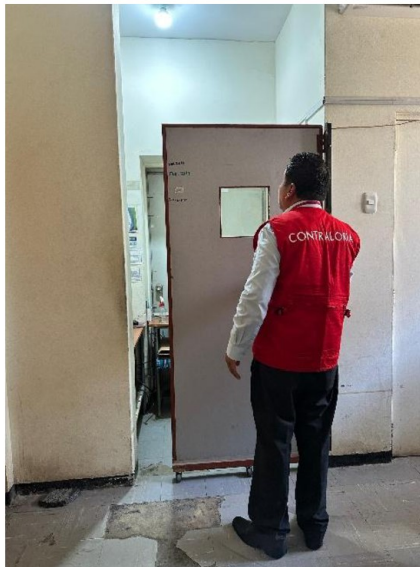
No cuenta con cabina cerrada.
