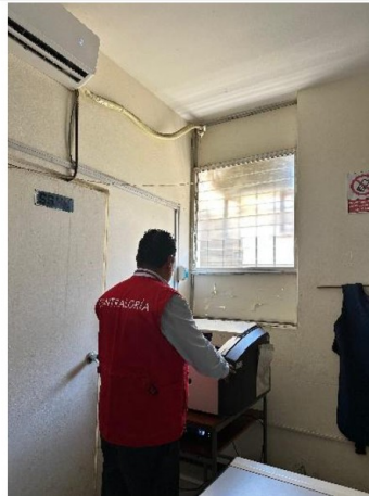
Ventana que comunica al exterior y puerta del SH sin protección de plomo.
