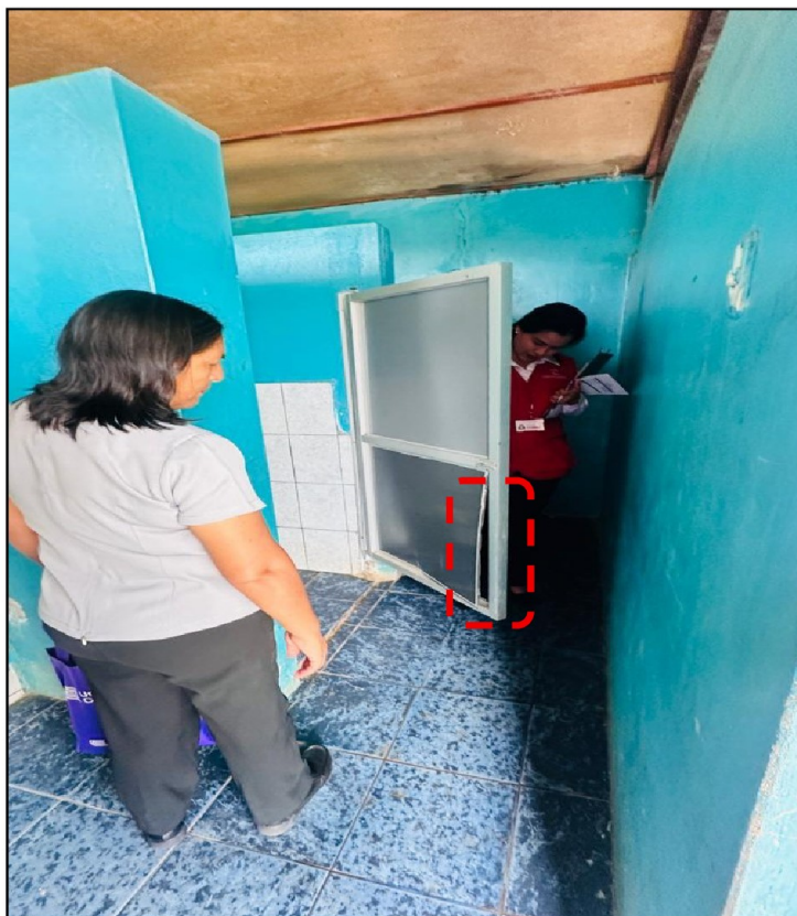
Imagen n.º 7 Puerta de servicios higiénicos mal estado
