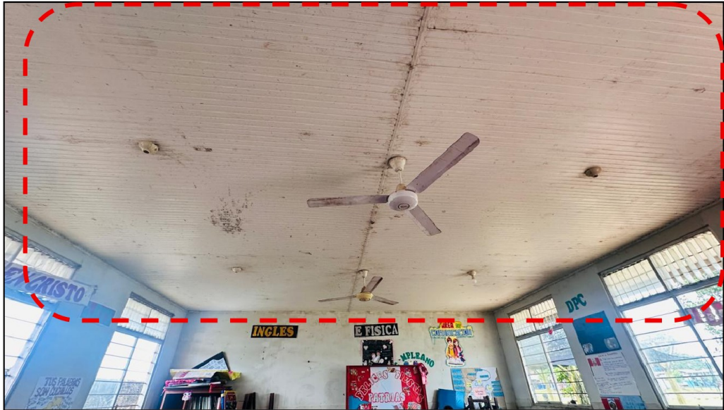
Imagen n.º 4 Techo de aula con presencia de humedad y deterioro
