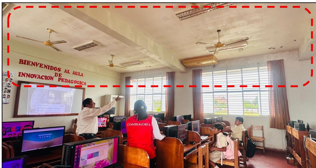
Imagen n.º 17 Sala de cómputo se verifica presencia de humedad
