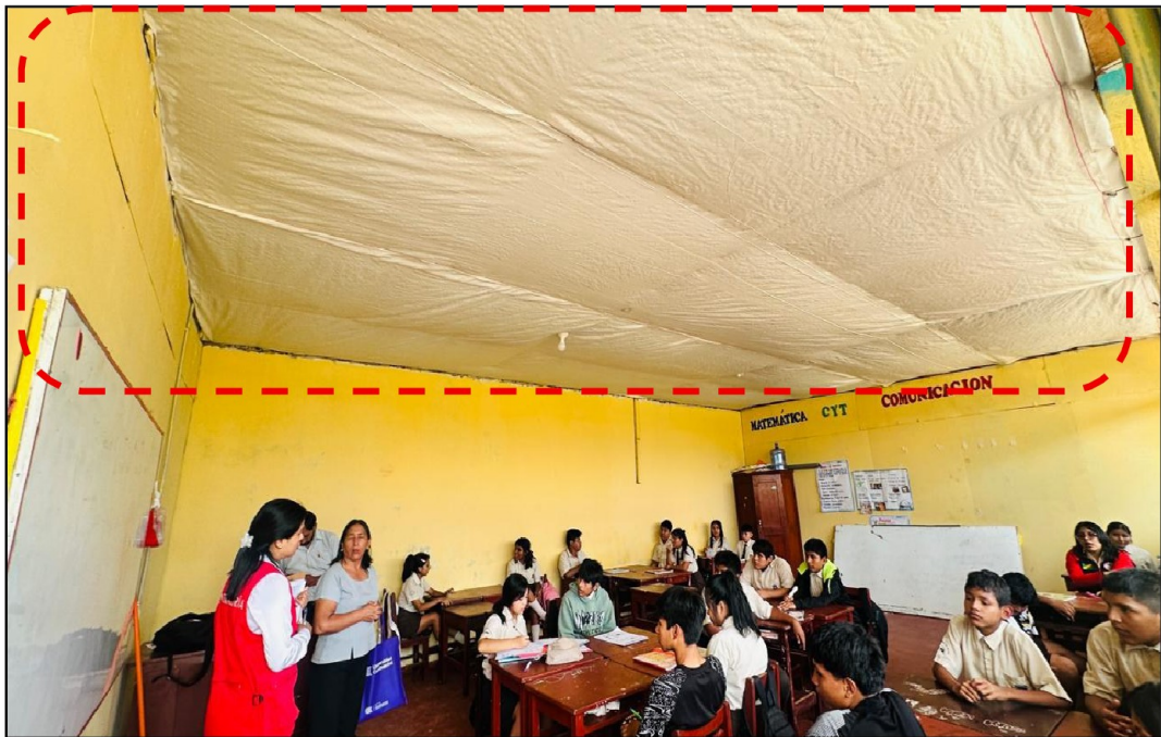
Imagen n.º 5 Techo de aula con cielo raso de polietileno
