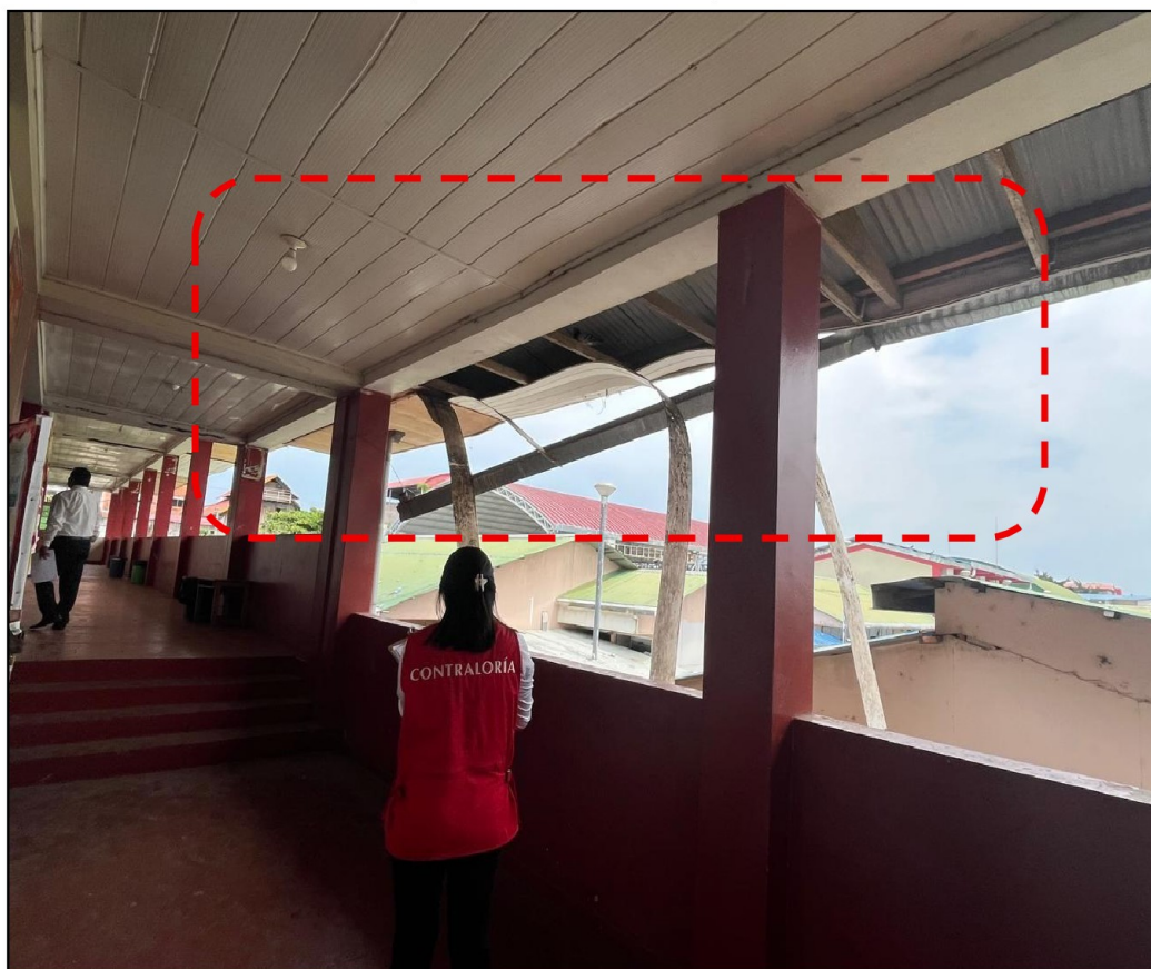
Imagen n.º 18 Pasillo aulas nivel primaria/ secundaria, con presencia de deterioro
