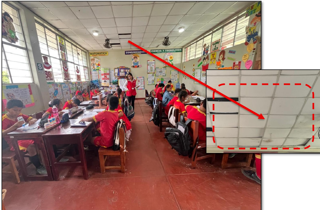
Imagen n.º 16 Cielo raso en deterioro, se verifica presencia de humedad
