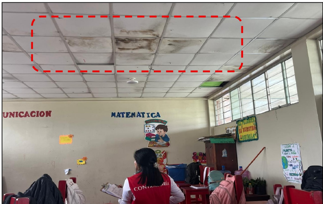
Imagen n.º 13 Cielo raso con presencia de humedad
