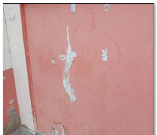
Paredes de aulas de I.E. 88024 Las Brisas que presenta descascamiento de pintura.
