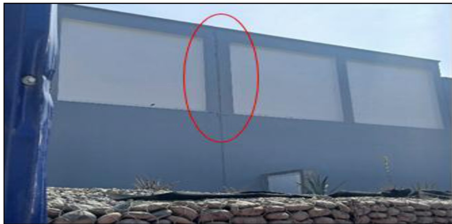
Se puede visualizar que el cerco perimétrico presenta rajaduras, requiriendo mantenimiento.
