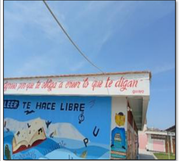
Techo de la Biblioteca de la I.E. 88011 Inca Garcilazo de la Vega (El Trapecio), que muestra fisuras en el acabado de la parte exterior de la viga y la losa.
