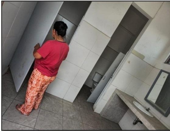
Falta de mantenimiento en los Servicios higiénicos del nivel secundario
