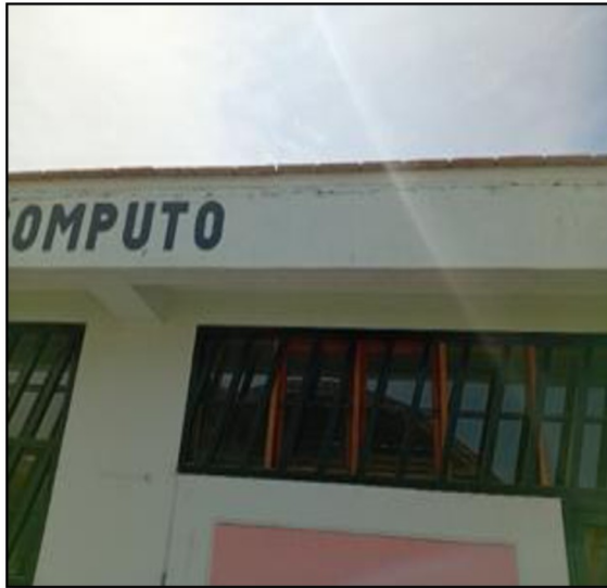
Techo del Centro de Cómputo de la I.E. 88011 Inca Garcilazo de la Vega (El Trapecio), que muestra fisuras en el acabado de la parte exterior de la viga y la losa.
