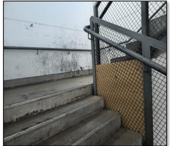
Falta de mantenimiento en escaleras y paredes del nivel secundario
