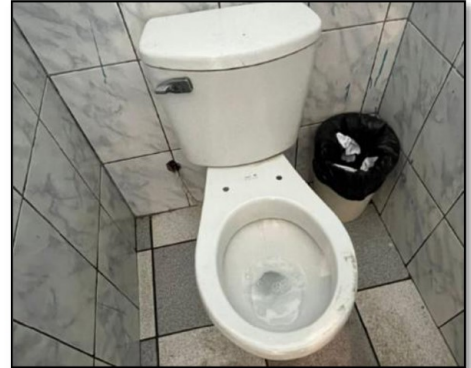
Inodoro con fugas de aguas en los ss.hh – I.E 86017 Sabio Antonio Raimondi
