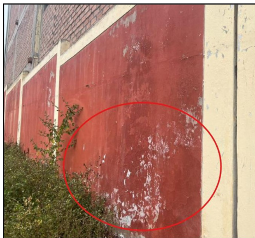
Humedecimiento y deterioro del muro del cerco perimétrico por posibles filtraciones de agua producto del riego – I.E 1579
