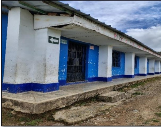
I.E 86758 Ciro Alegria Bazán cuenta con algunos techos en mal estado
