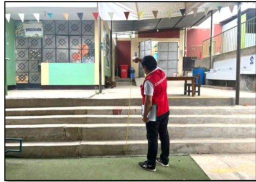
Desnivel sin rampa del área de lavadero y dirección hacia el patio de la – I.E1579
