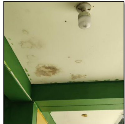
Humedecimiento por filtración en techo de pasadizo – I.E 356 Nuestra Señora de la Asunción
