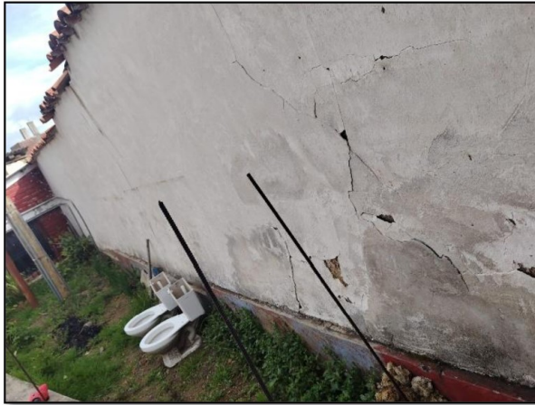
Cercos perimétricos (punto 1) expuestos a filtración de agua por riego en áreas de cultivo contiguas – II.EE 86090-C.P. Chontayoc
