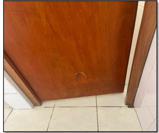
La puerta del SS. HH de varones presenta en la parte inferior daños – I.E N° 86694 "Fray Martin Milagroso"
