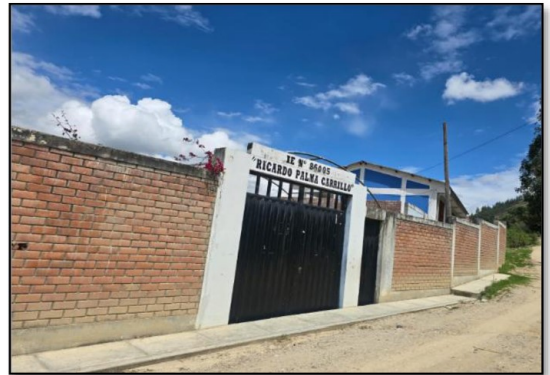
Cerco perimétrico presenta filtraciones de agua - I.E 86005 Ricardo Palma Carrillo
