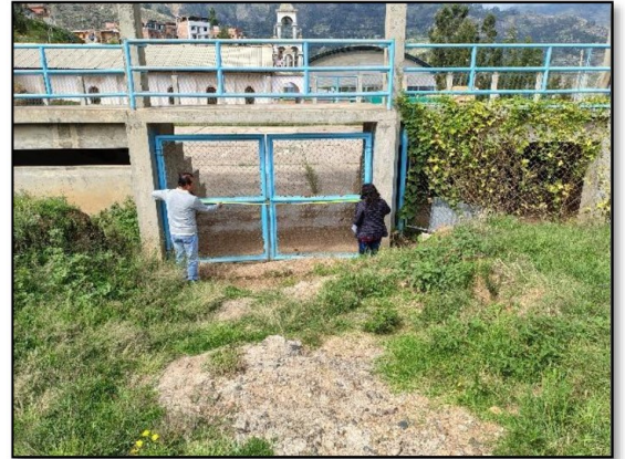
No se cuenta con rampas para acceso hacia la losa deportiva – I.E 86104 Augusto Alba Herrera
