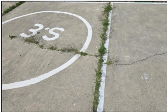
Piso de la losa deportiva presenta fisura - I.E 86005 Ricardo Palma Carrillo
