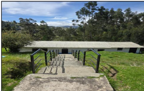
La II.EE no cuenta con rampa en el ingreso de la puerta este– I.E 86688 Virgen del Carmen
