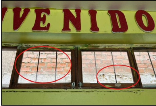
Vidrios en aulas rotos – I.E 86017 Sabio Antonio Raimondi
