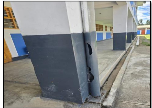
Tubería de drenaje pluvial rota - I.E 86005 Ricardo Palma Carrillo
