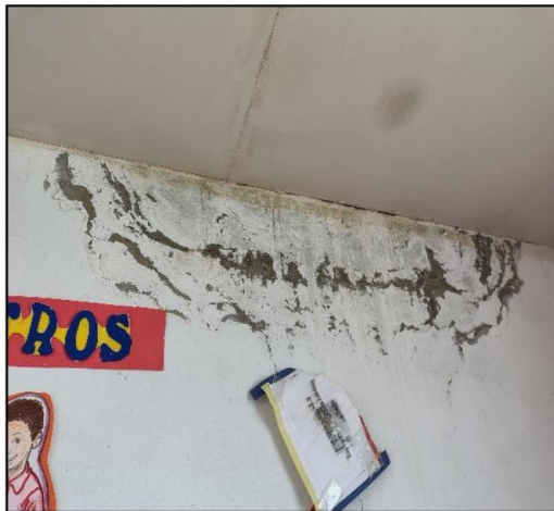
Se advierte presencia de filtraciones de agua en las aulas de la I.E 86758 Ciro Alegria Bazán
