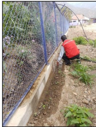
Cerco perimétrico (punto 1) expuesto a filtración de agua por riego en áreas de cultivo contiguo – II.EE 86701-Vitoca-Pariacoto
