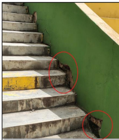
Pérdida de recubrimiento del concreto en pasamanos para acceso escaleras – I.E 356 Nuestra Señora de la Asunción
