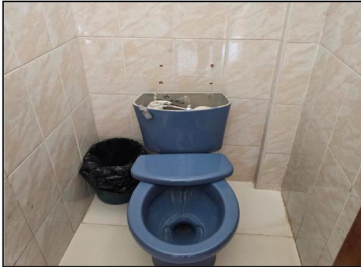
Servicio higiénico con fuga de agua - I.E 86005 Ricardo Palma Carrillo
