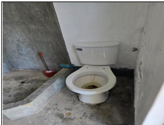
Servicio higiénico con fuga de agua - I.E 86688 Virgen del Carmen
