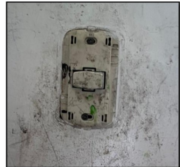
Interruptor dañado – I.E 86017 Sabio Antonio Raimondi
