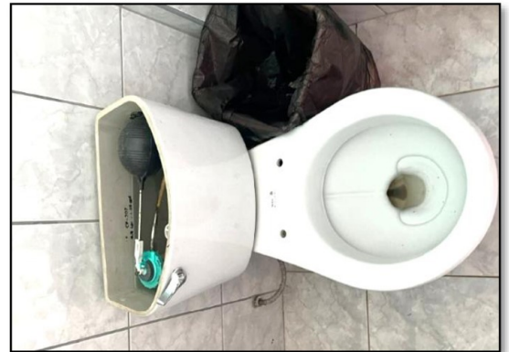
Inodoro sin tapa de tanque nivel inicial – I.E 86066 Mártires y Miguel Zbigniew
