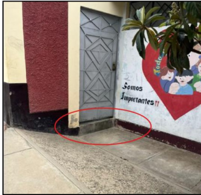
Desnivel sin rampa en la segunda puerta de ingreso de la – I.E1579
