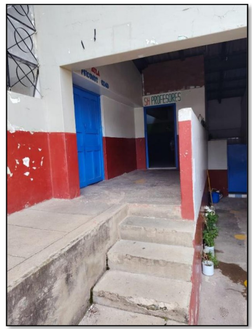
Paredes de II.EE. deterioradas por lluvias II.EE 86090- C.P. Chontayoc
