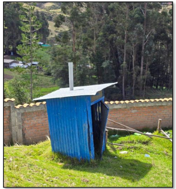
Uso de silo en mal estado - I.E 86688 Virgen del Carmen
