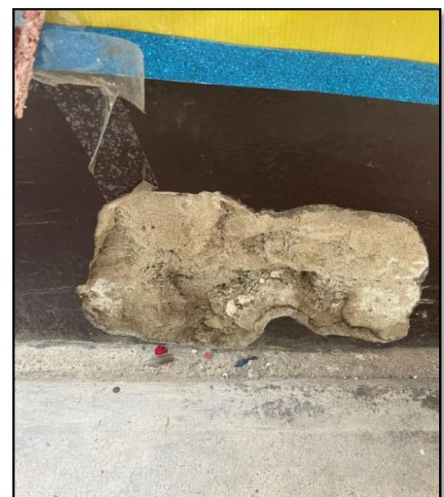
Perdida de recubrimiento de concreto en el cimiento del cerco perimétrico – I.E 1579
