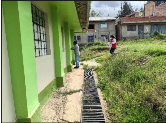
La vía de acceso a las aulas de las I.E 86104 Augusto Alba Herrera no cuenta con Rampa
