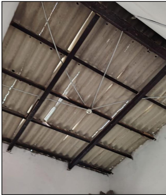
Techo de algunos ambientes de la II.EE. cuentan con calaminas rotas – II.EE 86090- C.P. Chontayoc
