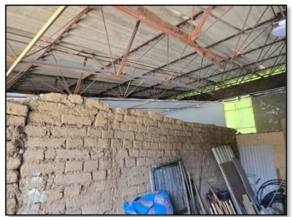
Ambiente en mal estado- I.E 86688 Virgen del Carmen
