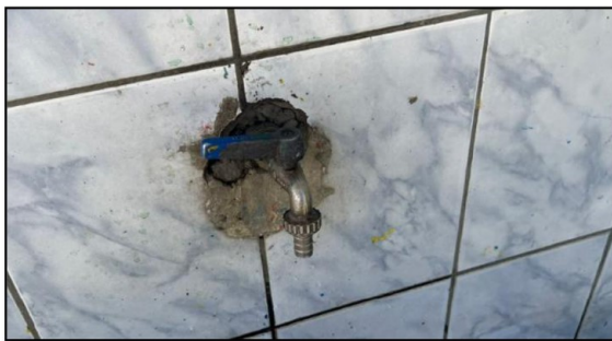
Muro de lavadero dañado – I.E 86017 Sabio Antonio Raimondi
