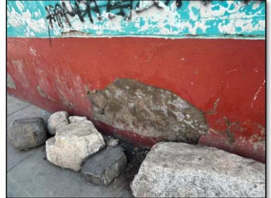
Pérdida de recubrimiento de acabado de concreto y humedecimiento en el cimiento del cerco perimétrico – I.E 86017 Sabio Antonio Raimondi
