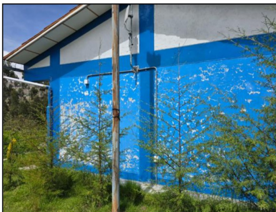
Paredes con humedad y descascarados - I.E 86688 Virgen del Carmen
