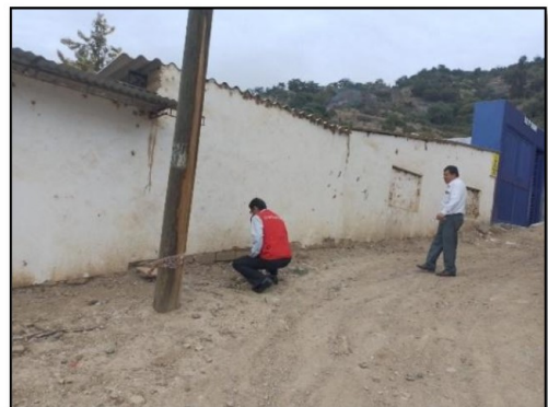
Cerco perimétrico no cubre todo el perímetro de la II.EE – II.EE 86701-Vitoca-Pariacoto
