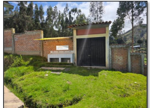
No se cuenta con rampas para acceso de la puerta del lado sur – I.E 86688 Virgen del Carmen
