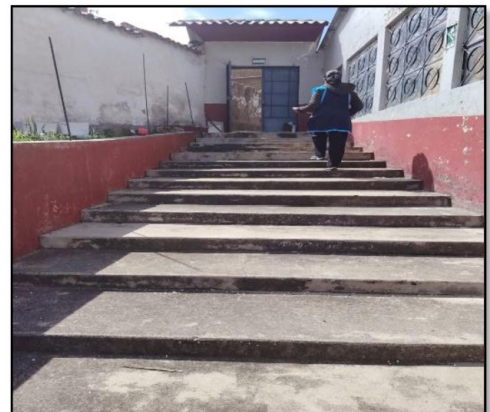
La I.E no cuenta con rampa de ingreso, las escaleras no cuentan con baranda – I.E 86090 - Chontayoc
