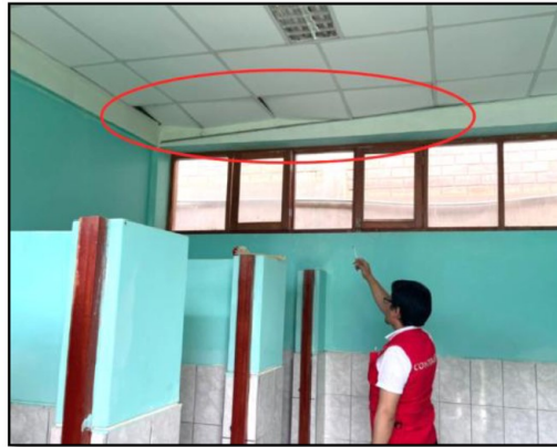
Falso cielo raso de baldosa acústica dañada y con peligro de caída ss.hh inicial – II.EE 86066 Mártires y Miguel Zbigniew
