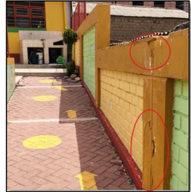
Presencia de fisuras en las columnas y pérdida de recubrimiento de concreto – I.E 356 Nuestra Señora de la Asunción
