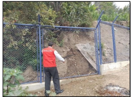
Cerco perimétrico (punto 2) expuesto a filtración de agua por riego en áreas de cultivo contiguo – II.EE 86701-Vitoca-Pariacoto
