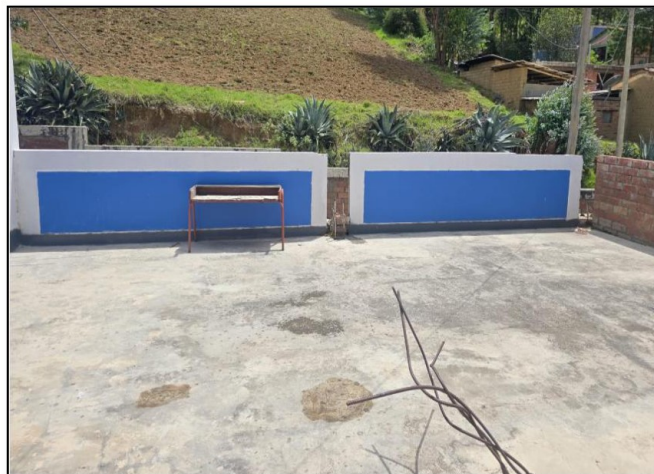
Fierros de construcción expuestos espacios entre muretes - I.E 86005 Ricardo Palma Carrillo
