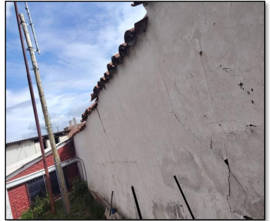
Cercos perimétricos (punto 2) expuestos a filtración de agua por lluvias - II.EE 86090- C.P. Chontayoc
