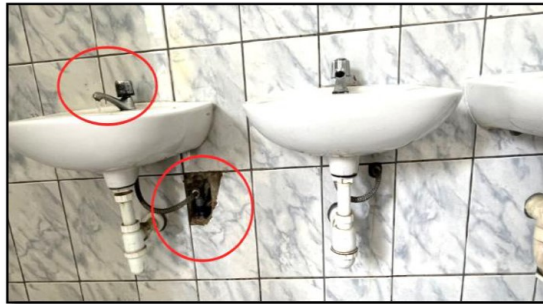
Muros con acabado de cerámica dañados y caños mal fijados – I.E 86017 Sabio Antonio Raimondi
