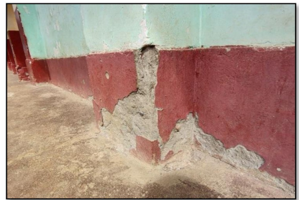
Deterioro de las paredes de la II.EE 86104 Augusto Alba Herrera
