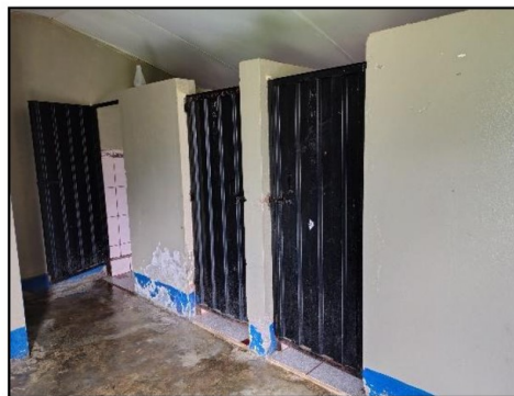
Se advierte deterioro de las paredes de los servicios higiénicos de la I.E 86758 Ciro Alegria Bazán
