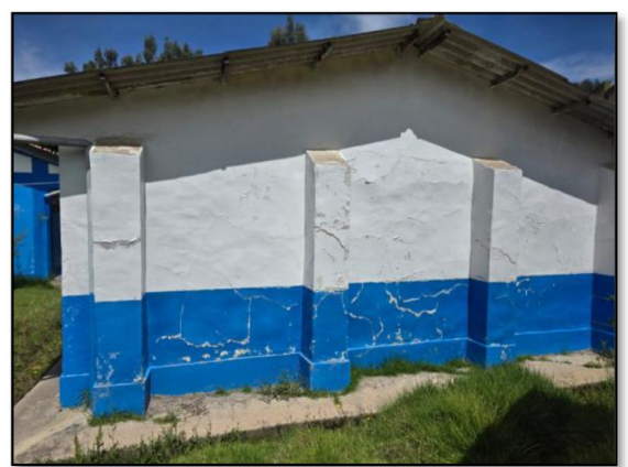
Paredes con fisuras - I.E 86688 Virgen del Carmen
