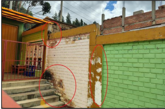
Presencia de humedad y pérdida de pintura en el cerco perimétrico – I.E 356 Nuestra Señora de la Asunción
