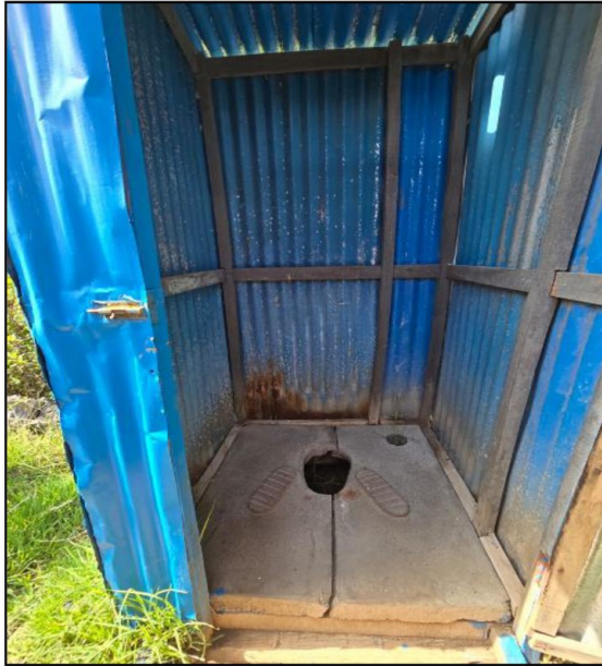
Uso de silo en mal estado - I.E 86688 Virgen del Carmen
