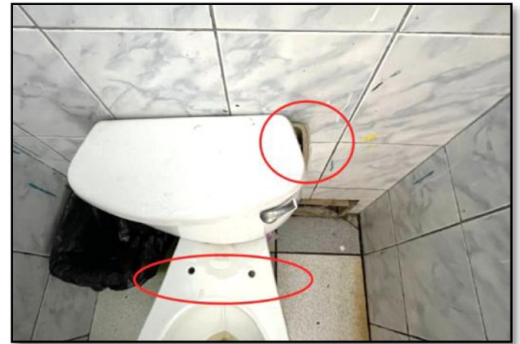
Inodoro con tapa de tanque mal fijada – I.E 86017 Sabio Antonio Raimondi
