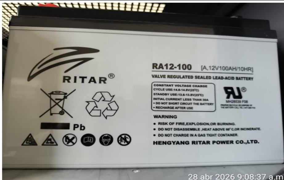
Característica de las baterías instaladas en el mes de abril de 2025, que forma parte del banco de baterías de la central de UPS del tomógrafo.
