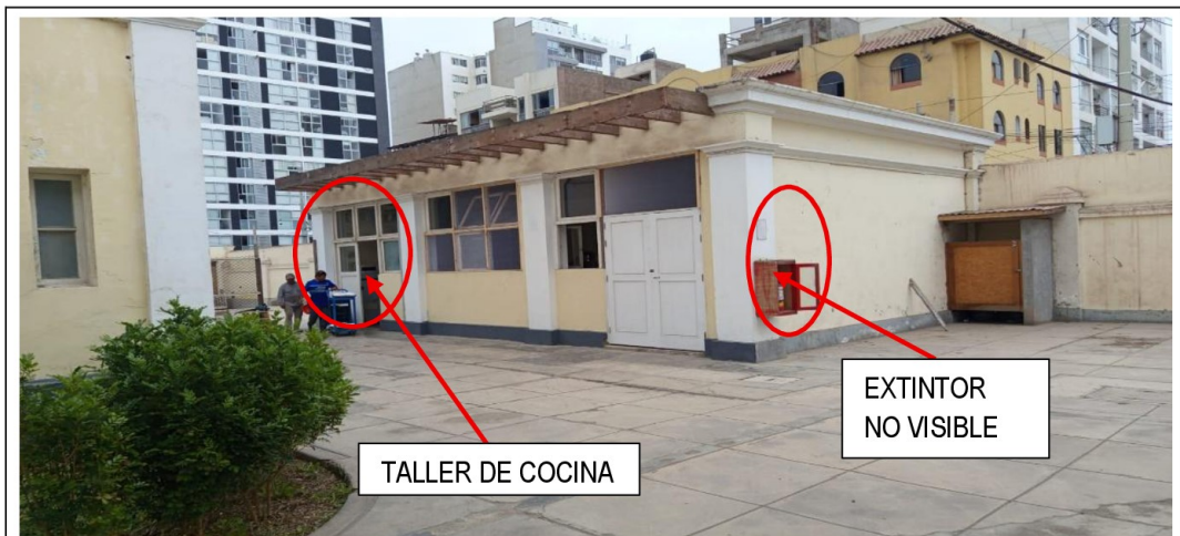
Imagen n.º 14 Extintor portátil con ubicación inadecuada
