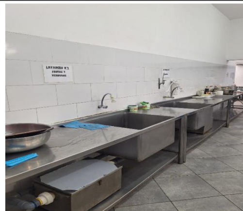
Falta de señalización y luces de emergencia
