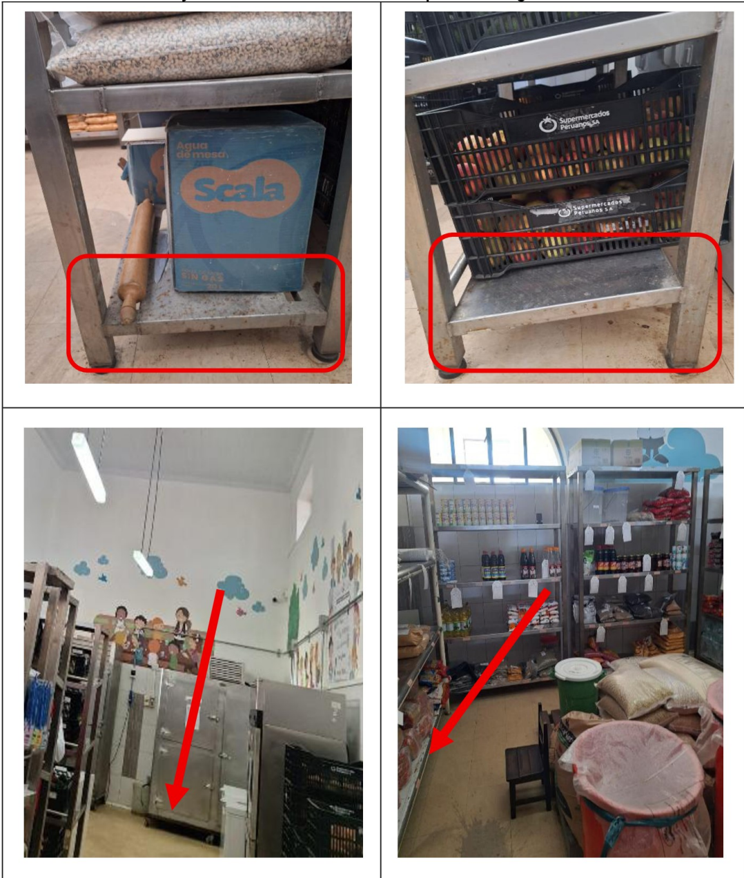
Imagen n.º 8 Conservadoras y los estantes metálicos de la Despensa con signos de oxidación
