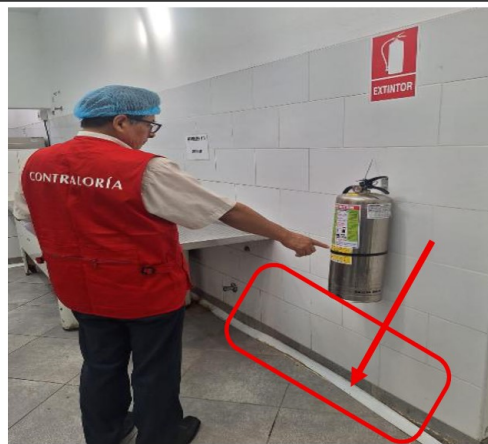
Zócalos en mal estado
