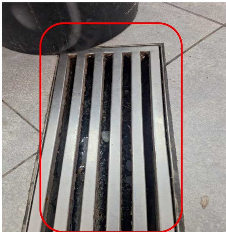
Imagen n.º 5 Trampa de grasa principal de la cocina obstruida
