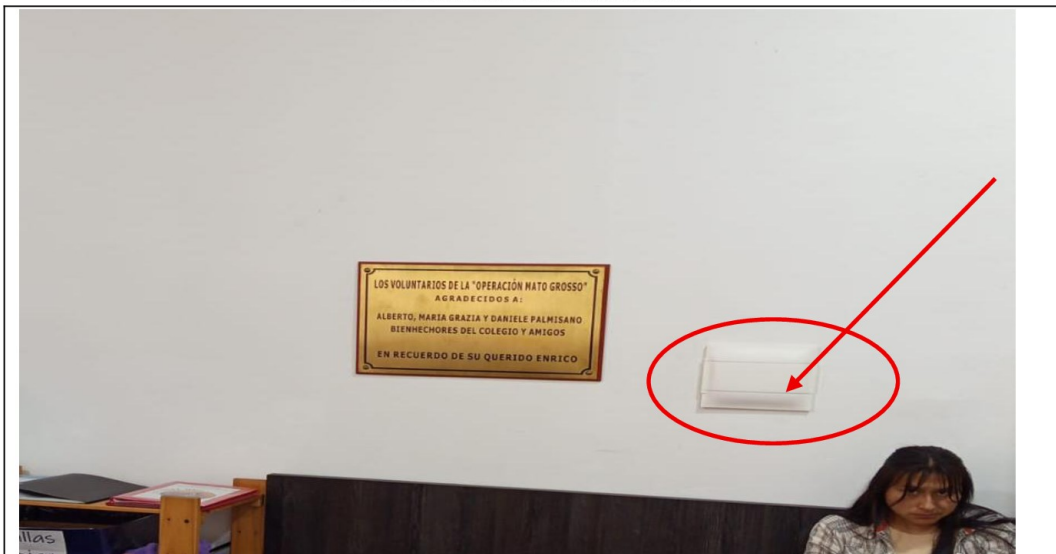
Imagen n.º 12 Tablero eléctrico sin señalización
