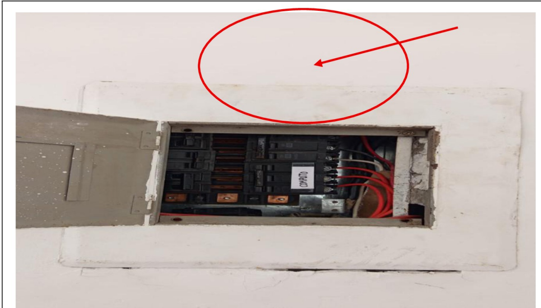
Imagen n.º 11 Tablero eléctrico sin señalización
