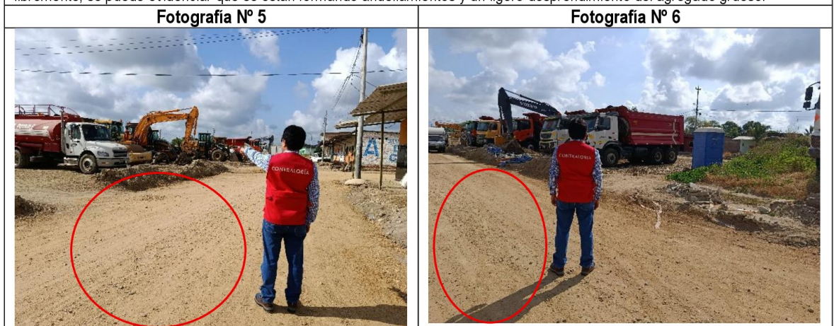
Fotografía N° 5 y Fotografía N° 6: En la Av. San Martín, durante el recorrido, se ha evidenciado que carros y mototaxis transitan libremente, se puede evidenciar que se están formando ahuellamientos y un ligero desprendimiento del agregado grueso.
