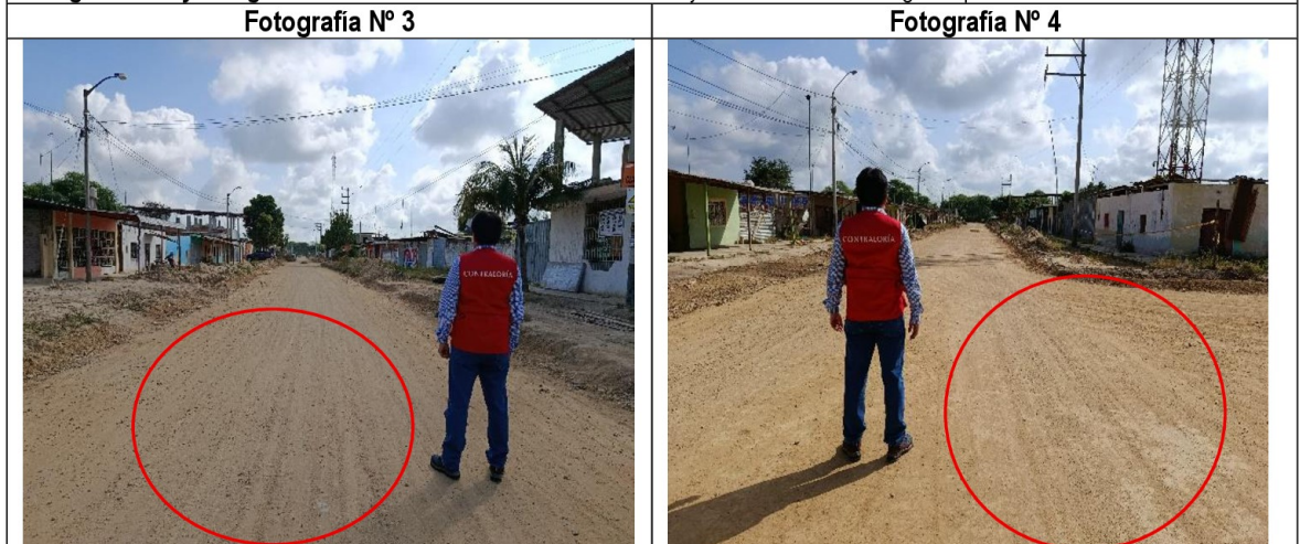
Fotografía N° 3 y Fotografía N° 4: Calle Capitán Hoyle, durante el recorrido, se ha evidenciado que carros y mototaxis transitan libremente, se puede evidenciar que se están formando ahuellamientos y un ligero desprendimiento del agregado grueso.
