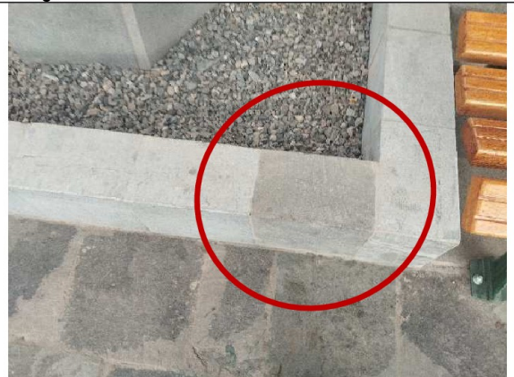
Fotografía n.º 20: Falta de uniformidad en el color en sardinel de áreas verdes.
