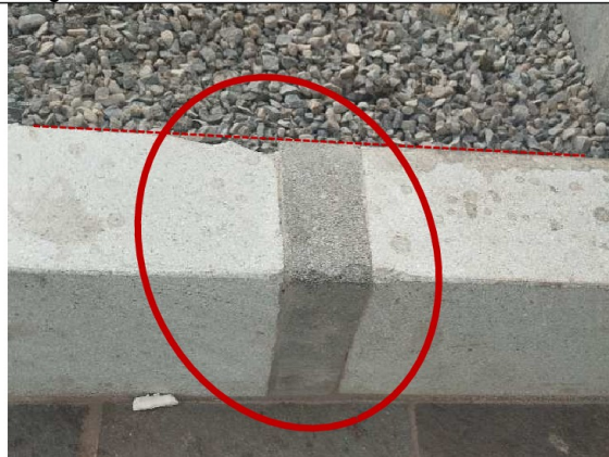
Fotografía n.º 19: Falta de uniformidad en el color, además de presentar irregularidad en su corte en sardinel de áreas verdes.
