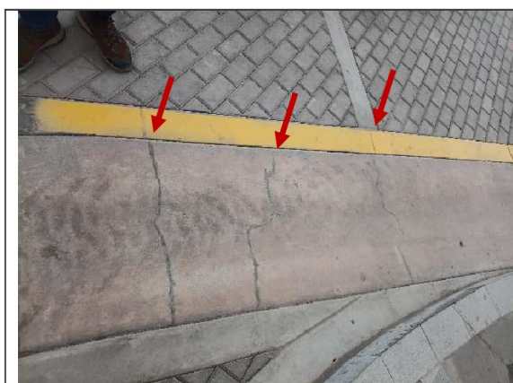
Fotografía n.º 15: Fisuras transversales sobre la tapa del canal de evacuación de aguas pluviales.
