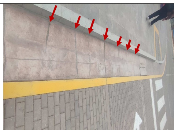
Fotografía n.º 16: Fisuras transversales sobre la tapa del canal de evacuación de aguas pluviales.
