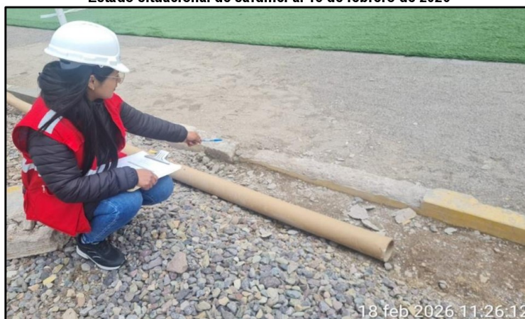
Imagen n.º 16 Estado situacional de sardinel al 13 de febrero de 2026
