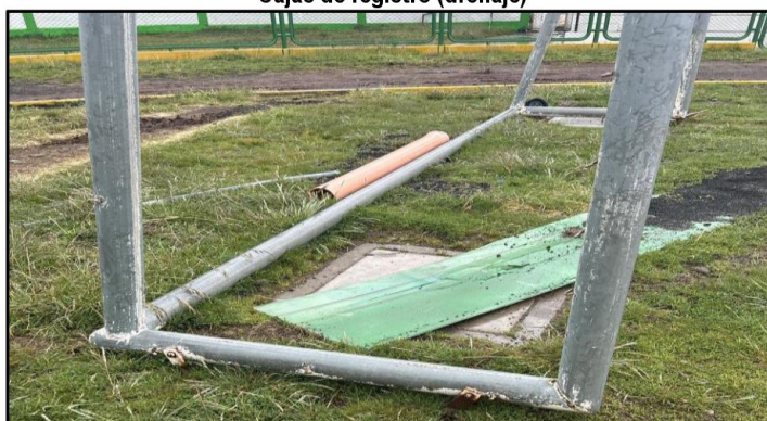
Imagen n.º 22 Cajas de registro (drenaje)
