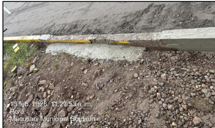
Imagen n.º 15 Estado situacional de sardinel al 13 de febrero de 2026
