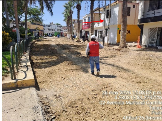
Poste de alumbrado público a reubicar.
