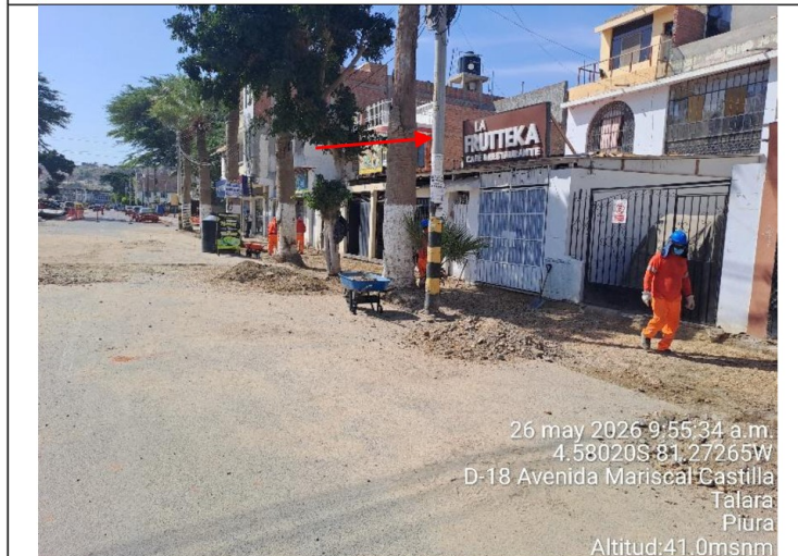
Poste de alumbrado público a reubicar.
