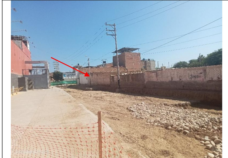
Poste de alumbrado público a reubicar.
