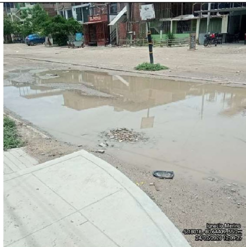
Fotografía n.º 14.- Nótese, como el estancamiento de agua de lluvia interfiere con el acceso a la rampa de discapacitados.
