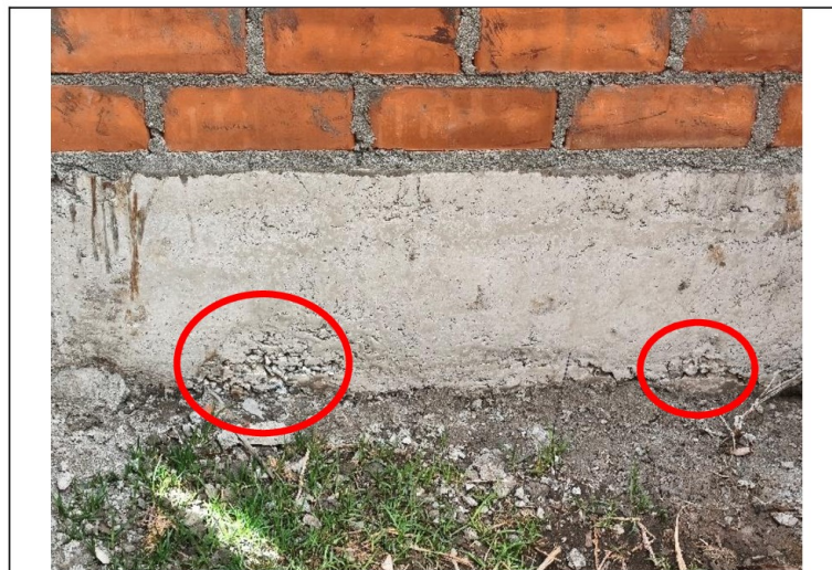
Cangrejas en la superficie del sobrecimiento de caseta.
