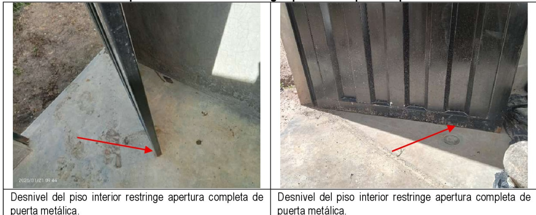
Panel fotográfico n.º 5 Desnivel del piso interior de UBS restringe apertura completa de puerta metálica
