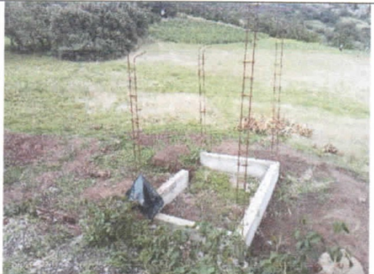
Presencia de óxido en el acero de refuerzo de columnetas de UBS.
