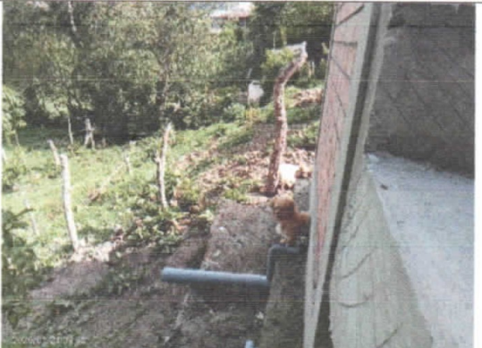
Instalaciones sanitarias en exterior de UBS.
