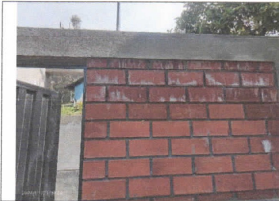
Presencia de manchas blanquecinas en muro de UBS.
