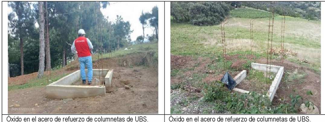
Óxido en el acero de refuerzo de columnetas de UBS.
