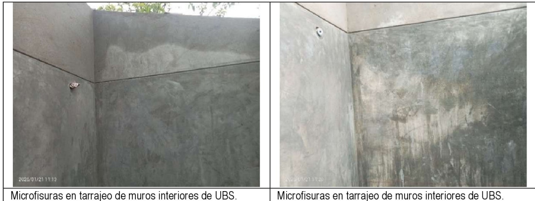
Microfisuras en tarrajeo de muros interiores de UBS.
