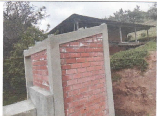
Presencia de manchas blanquecinas en muro de UBS.
