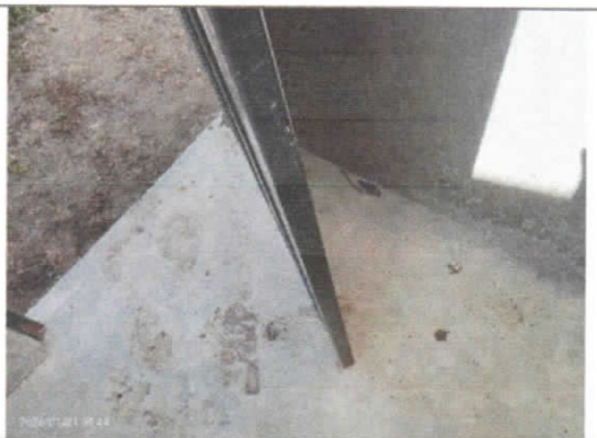
Puerta metálica que no abre por completo.
