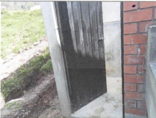
Puerta metálica que no abre por completo.
