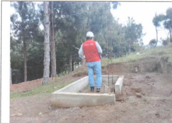
Presencia de óxido en el acero de refuerzo de columnetas de UBS.
