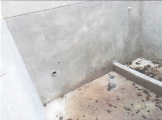
Instalaciones sanitarias en interior de UBS.
