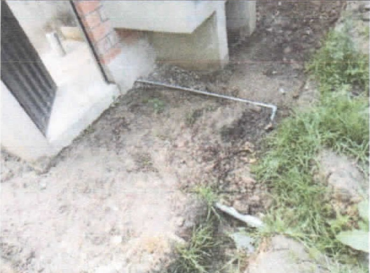
Instalaciones sanitarias en exterior de UBS.
