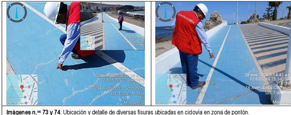
Imágenes n.ºs 73 y 74: Ubicación y detalle de diversas fisuras ubicadas en ciclovía en zona de pontón.
