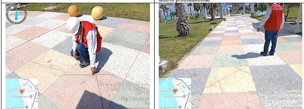
Imágenes n.ºs 55 y 56: Resanes de fisuras con aluminio de las formas más diversas, en este caso se tiene líneas aisladas, otras se entrecruzan, perpendiculares entre si y que distorsionan la cuadrícula existente.
