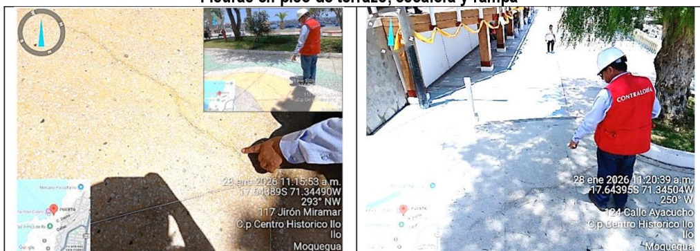
Imagen n.º 95: Fisura en caminería principal cercano al estar 01
