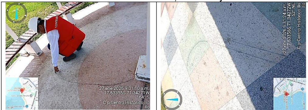
Imagen n.º 53: Resanes con perfil de aluminio en glorieta, en forma de arco irregular, transversal a juntas existentes y con extensión a tres paños de terrazo
