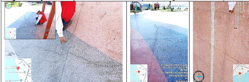
Imagen n.º 46: Resanes con perfiles de aluminio en las inmediaciones de plazuela 01 que abarca más de dos paños con 4 ramales.
