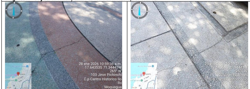
Imagen n.º 93: Fisura en perímetro de estar 02 transversal a anillos circulares en estar 02.
