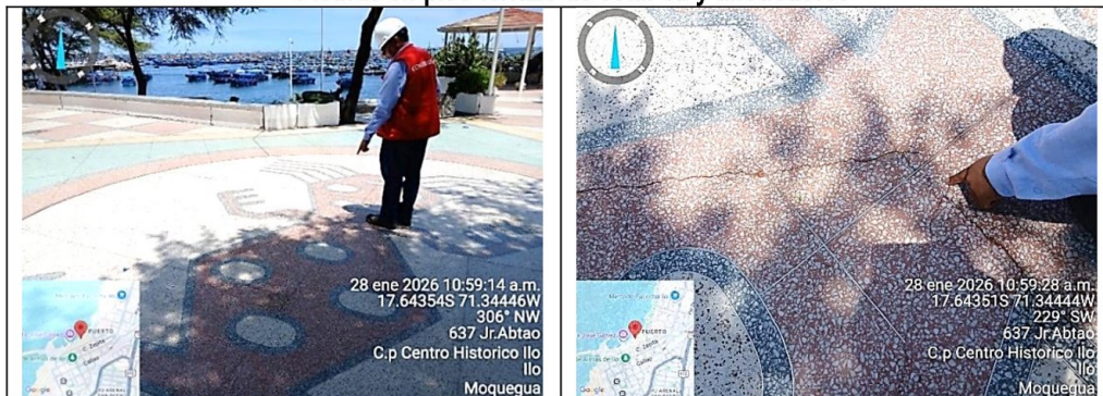
Imágenes n. os 91 y 92: ubicación y detalle de fisura en terrazo rojo de estar 02.
