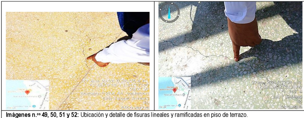
Imágenes n.ºs 49, 50, 51 y 52: Ubicación y detalle de fisuras lineales y ramificadas en piso de terrazo.
