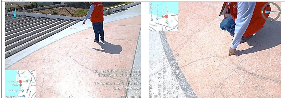
Imágenes n.ºs 77 y 78: Fisuras con perfiles de aluminio de geometría lineal errática y/o sinuosa en zona baja de escalera entre los miradores turísticos 3 y 4.
