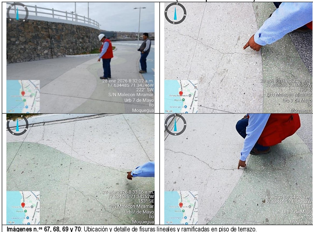
Imágenes n. os 67, 68, 69 y 70: Ubicación y detalle de fisuras lineales y ramificadas en piso de terrazo.
