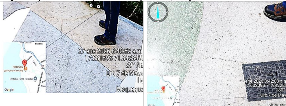
Imagen n.º 6: Fisura con ramificaciones que se extiende a más de un paño.
