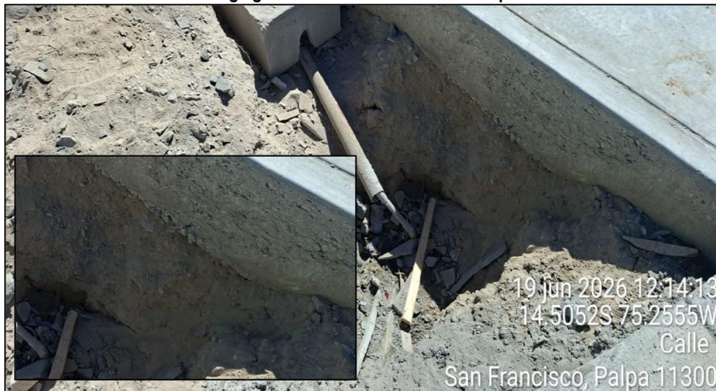
Imagen n.º 80 Segregación en uña de concreto de rampa
