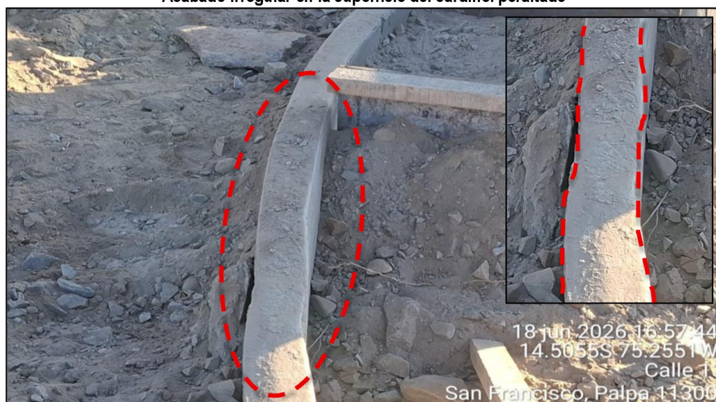
Imagen n.º 87 Acabado irregular en la superficie del sardinel peraltado
