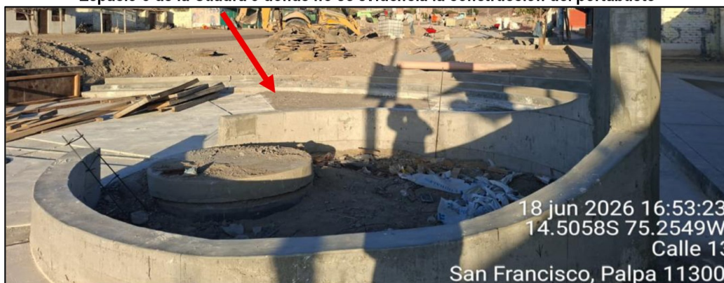
Imagen n.º 52 Espacio 3 de la Cuadra 3 donde no se evidencia la construcción del portabusto
