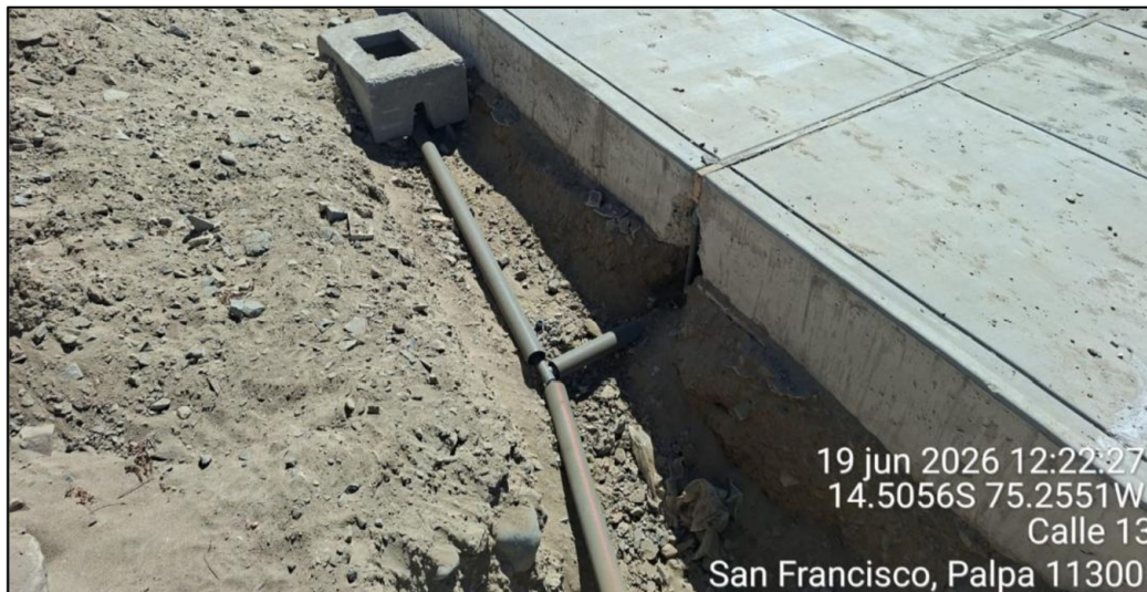
Imagen n.º 90 Ausencia de cama de arena en la instalación de tubería sanitaria
