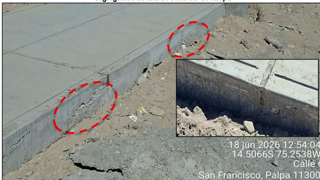
Imagen n.º 79 Segregación en uña de concreto de rampa
