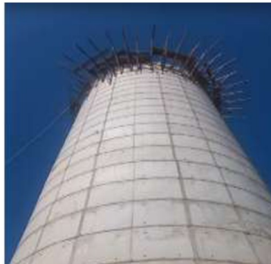
Imagen n.º 11 Reservorio de Cantalloc
