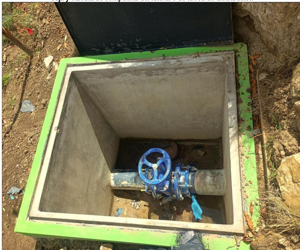
Fotografía n.º 2 Caja y válvula de compuerta del lateral 6 de la red de distribución
