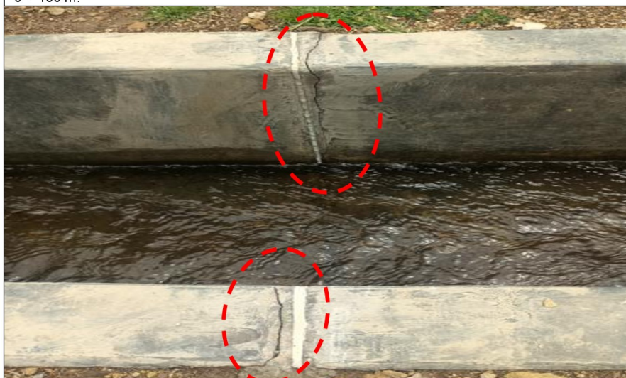
Se evidencia las fisuras en las paredes laterales del canal de concreto próximo a la progresiva 0 + 300 m.
