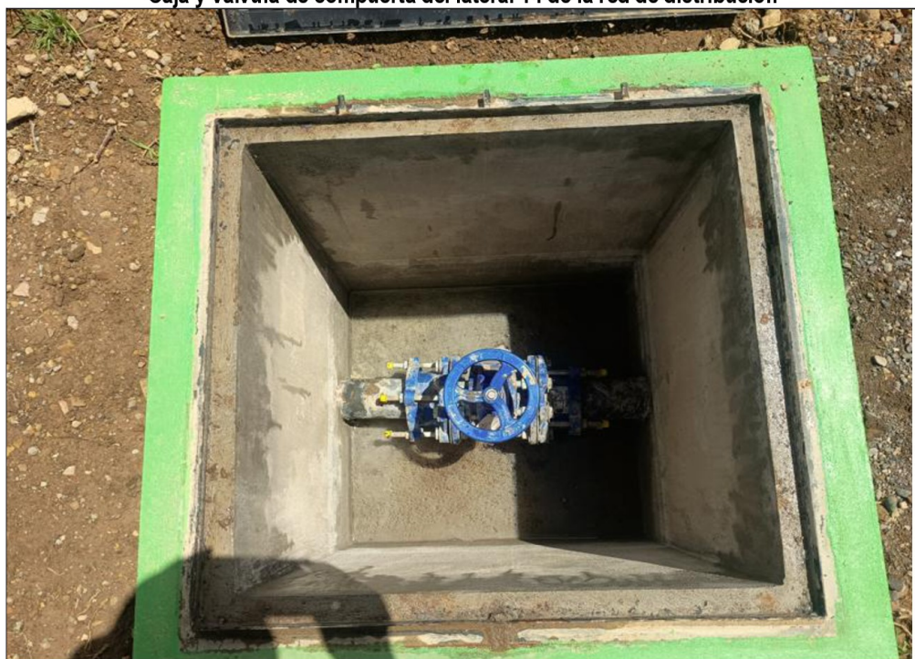
Fotografía n.º 1 Caja y válvula de compuerta del lateral 14 de la red de distribución
