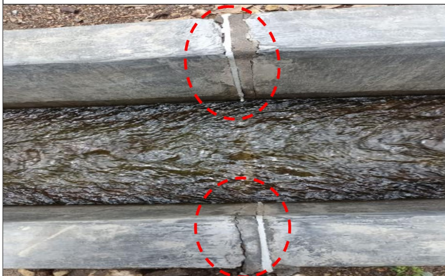
Se evidencia las fisuras en las paredes laterales del canal de concreto próximo a la progresiva 0 + 150 m.
