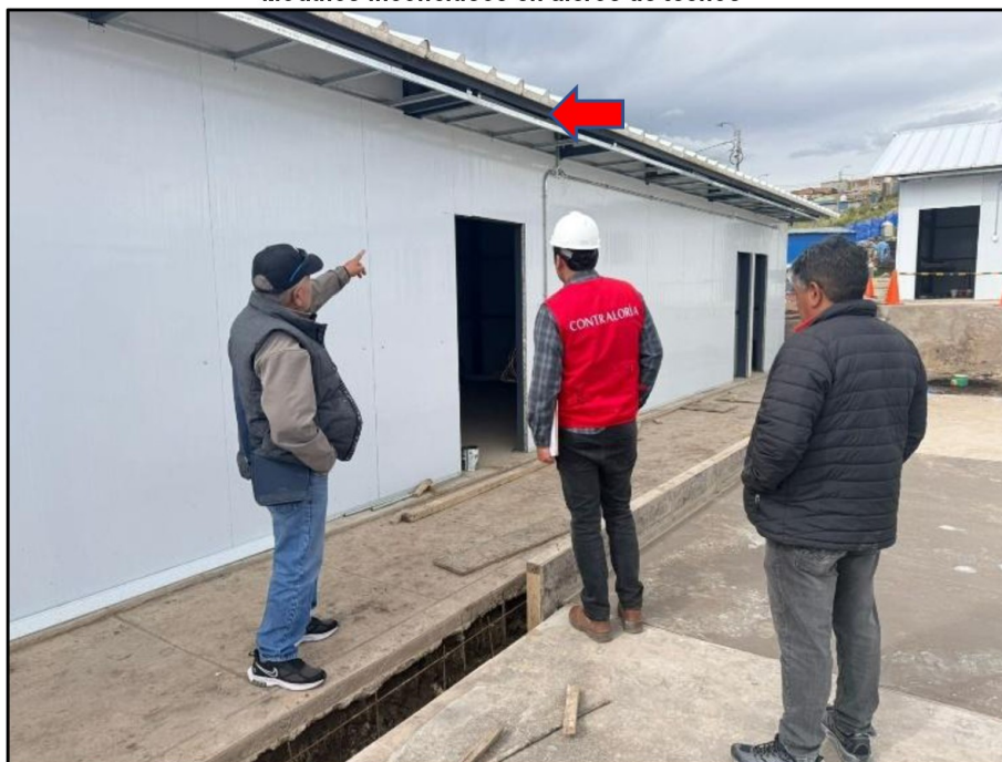
Imagen n.º 23 Módulos inconclusos en aleros de techos
