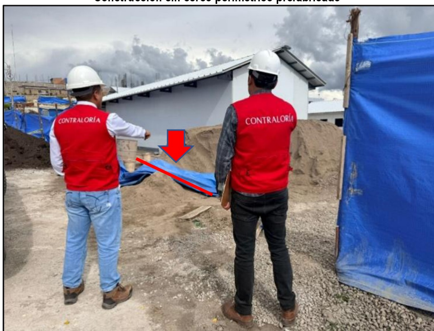
Imagen n.º 19 Construcción sin cerco perimétrico prefabricado
