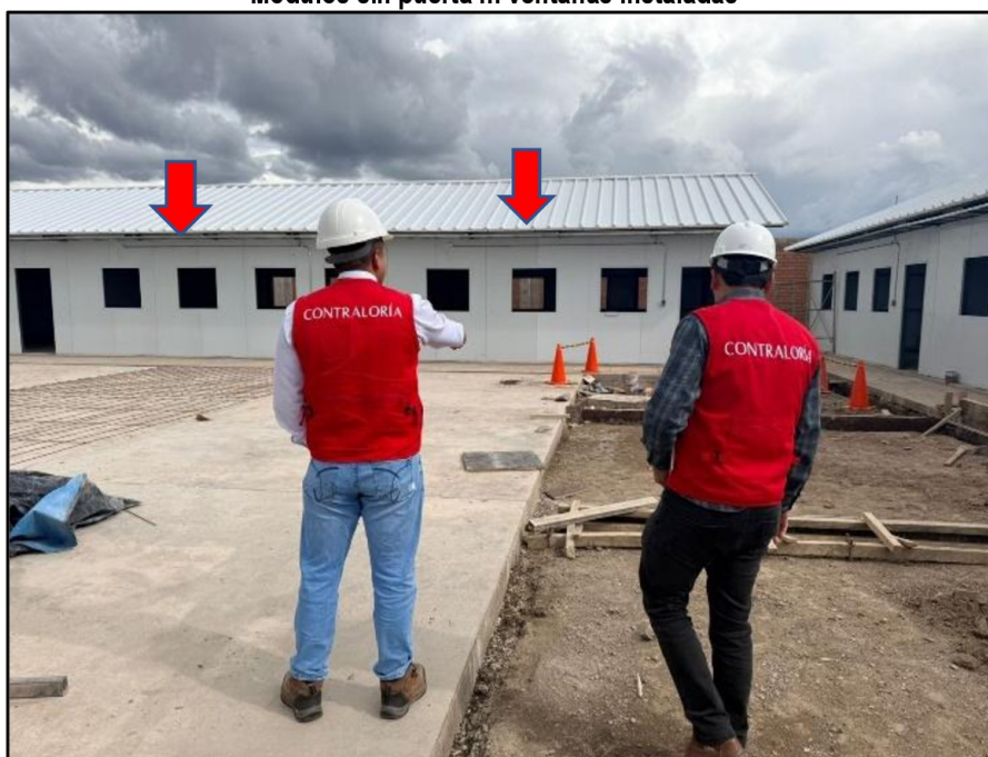
Imagen n.º 20 Módulos sin puerta ni ventanas instaladas
