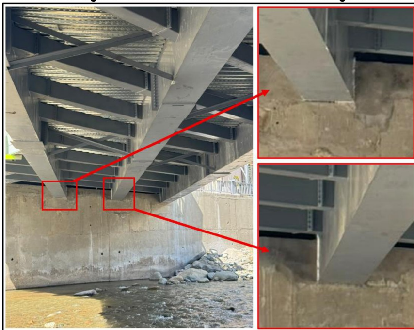
Imagen n.º 16 Invasión de vigas en muros de defensa ribereña existente - Margen derecho
