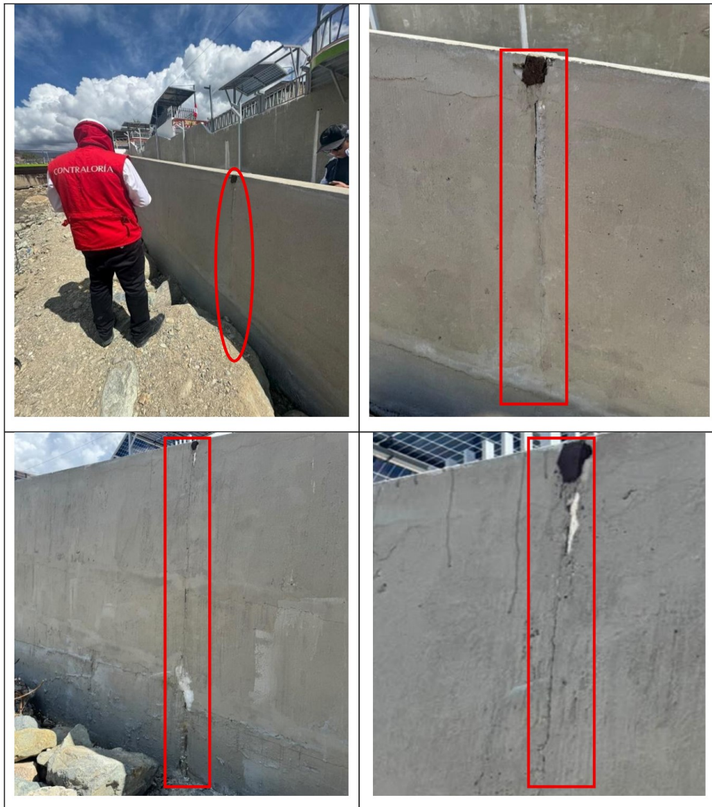
Cuadro n.º 6 Juntas de dilatación en muro de contención selladas de un solo lado
