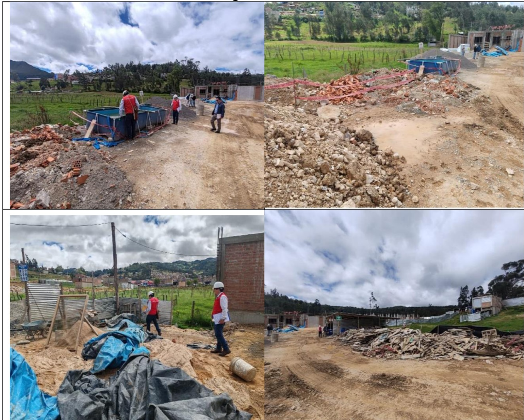
Se evidencia la falta de cerco perimétrico y caseta de vigilancia en determinados sectores de la obra, situación que no permite el adecuado control de ingreso y salida de personal, equipos y terceros ajenos a la ejecución de la obra.
