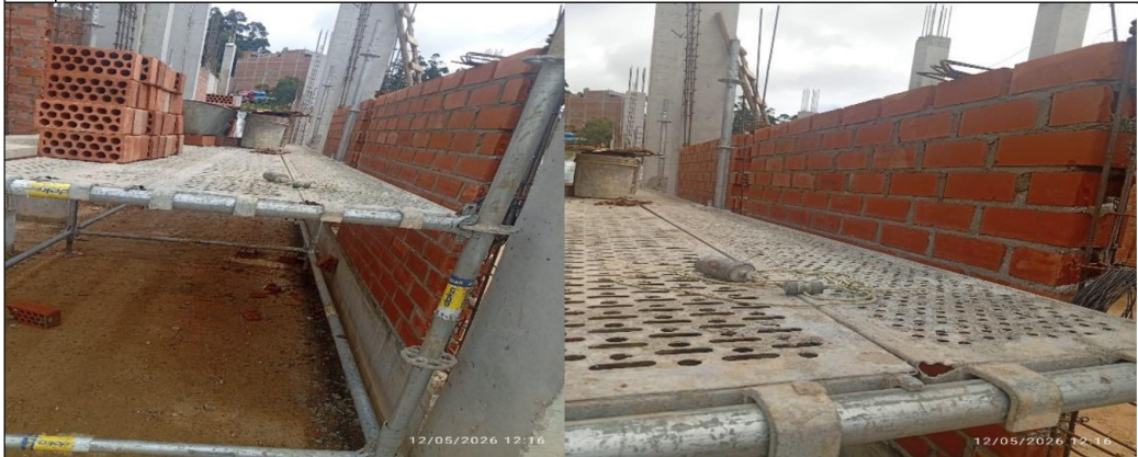
Ambiente donde se evidenció la presencia de trabajos de asentado de ladrillo en los ambientes sala de ecografías.
