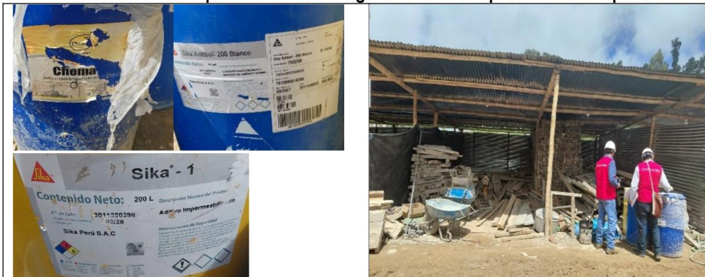
Se evidencia la existencia de aditivos para concreto expuestos a la intemperie, sin contarse con un lugar destinado para su adecuada manipulación y almacenamiento.
