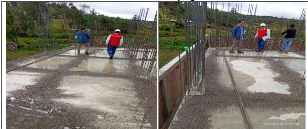
Señalización preventiva en altura inexistente considerando que se viene curando la losa de concreto del módulo 1 del proyecto.
