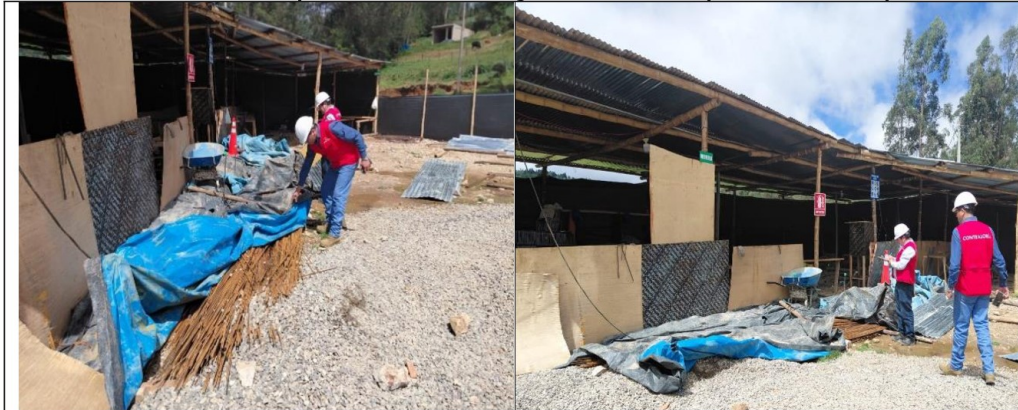
Almacenamiento de parte del acero expuesto a la intemperie en contacto directo con la humedad y el terreno natural.
