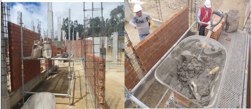
Ambiente donde se advirtió la realización de trabajos (asentado de ladrillo) en los ambientes donde funcionara el almacén de productos farmacéuticos, trabajos que se venían ejecutando a pesar que la obra se encontraba suspendida.
