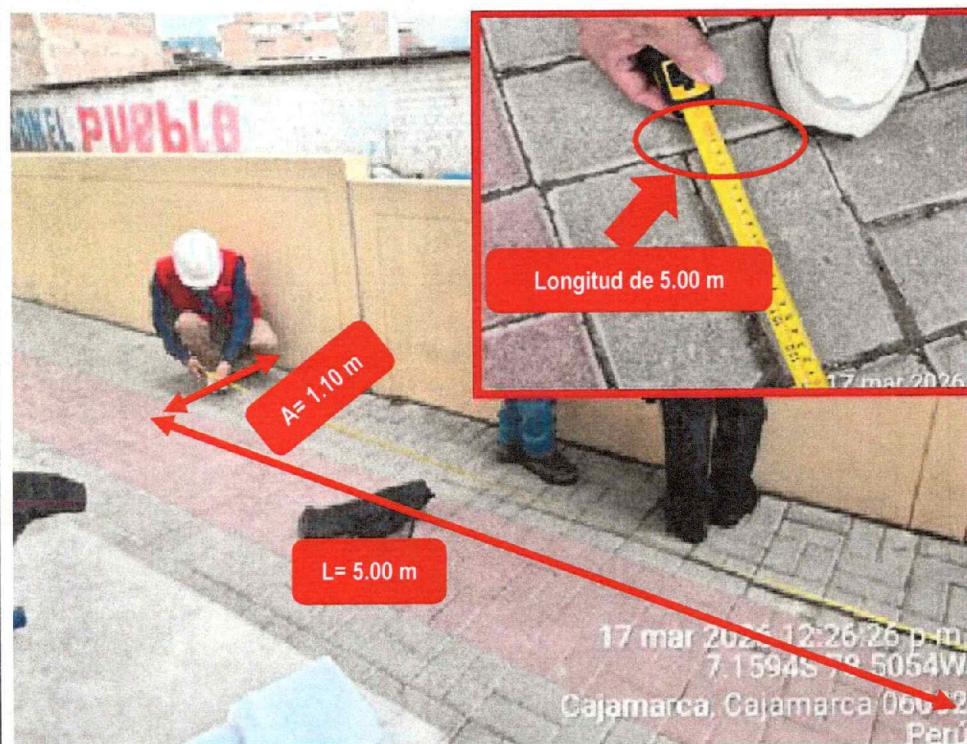
Fotografía n.º 26: Se evidenció hundimiento en la calzada peatonal adoquinada, ubicada entre la progresiva 0+547.93 a 0+552.93.
