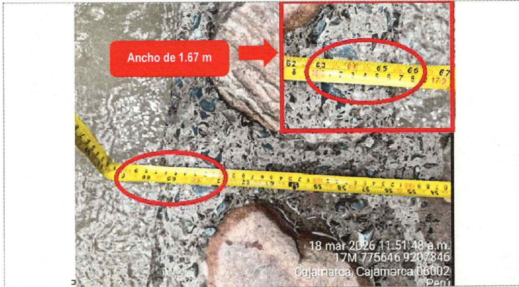
Fotografía n.º 11: En la coordenada UTM 775646 E y 9207846 N, se verificó el ancho de la construcción del mejoramiento con concreto ciclópeo de ancho de A = 1.67 m.
