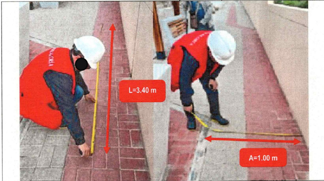
Fotografía n.º 22: Se evidenció hundimiento en la calzada peatonal, ubicada entre la progresiva 0+49.65 - 0+53.05 (odómetro).
