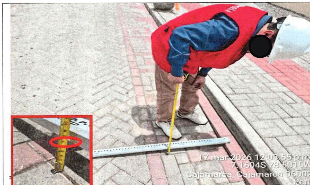
Fotografía n.º 21: Se evidenció hundimiento de 7 cm en el pavimento adoquinado, en un área de A=1.80 m de ancho y de una longitud de L= 2.80 m.
