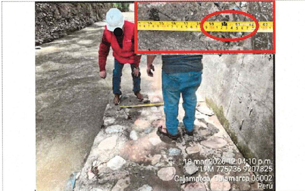
Fotografía n.º 15: En la coordenada UTM 775736 E y 9207825 N, se verificó el ancho de la construcción del mejoramiento con concreto ciclópeo de ancho de A = 1.57\text{m} .
