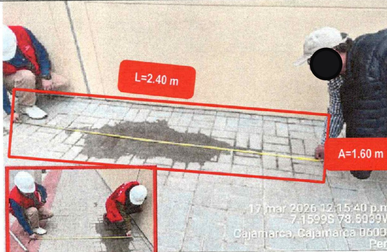
Fotografía n.º 24: Se evidenció hundimiento en la calzada peatonal adoquinada, ubicada entre la progresiva 0+372.50 - 0+374.90 .
