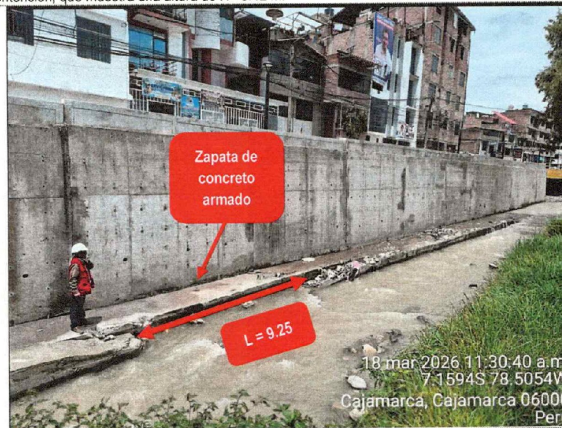
Fotografía n.º 18: Se observa en la imagen que 9.25 m no tienen la protección de la partida "Mejoramiento con concreto ciclópeo C:H 1:10+60% (Diámetro promedio de 0.80 m)", verificándose la zapata del muro de concreto armado de la defensa riverénea expuesta.
