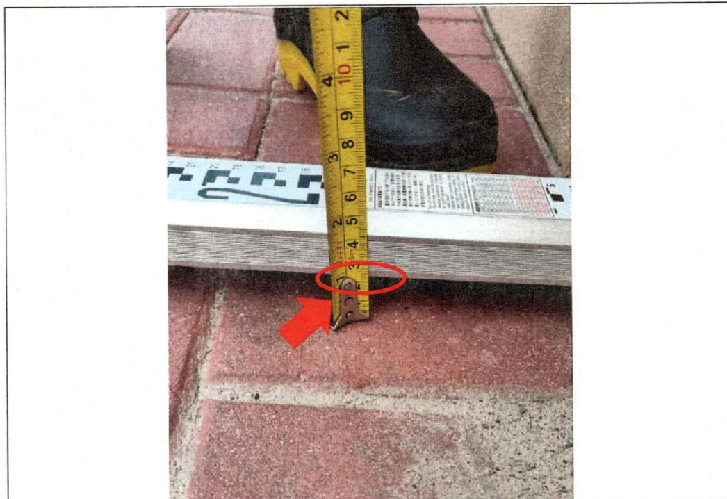
Fotografía n.º 23: Se evidenció hundimiento de 2.5 cm en la calzada peatonal adoquinado, en un área de A=1.00 m de ancho y de una longitud de L=3.40 m.
