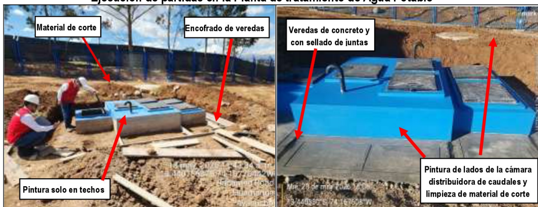
Imagen n.° 1: El 18 de mayo de 2026, se observa el proceso de encofrado de veredas en torno a la cámara distribuidora de caudales de la Planta de tratamiento de Agua Potable – PTAP; asimismo, se observa que los lados de la cámara se encuentran sin pintura y en los alrededores se encuentra el material de corte.
