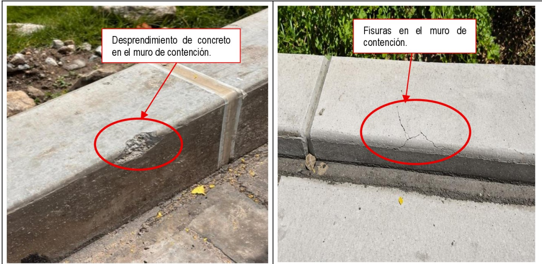
Fotografías n.º 21 al 24: Se evidencia deterioro y desprendimiento en muros de contención, así como fisuras en la estructura.
