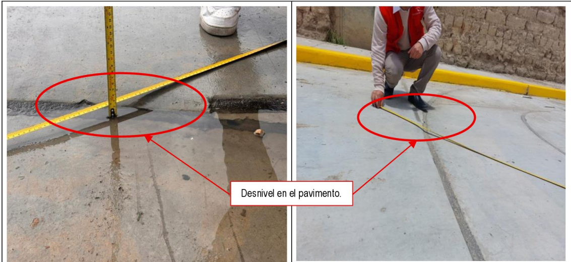
Fotografía n.º 34 y 35: Se observa un desnivel en la junta entre losas del pavimento de concreto, generando una diferencia de altura perceptible entre ambas superficies.
