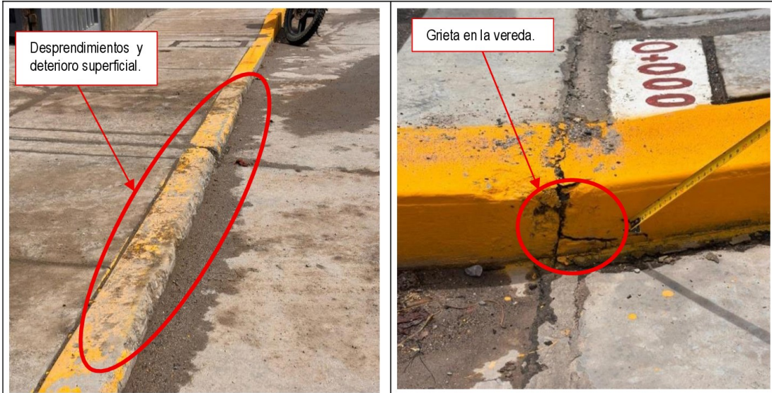
Fotografías n.º 17 al 20: Se evidencia fisuras y grietas en la estructura de las veredas, así como, desprendimientos del recubrimiento superficial en las veredas.
