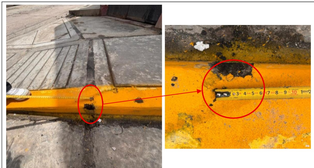
Fotografía n.º 9: Se observa que la junta asfáltica de la vereda es de 5 cm.
