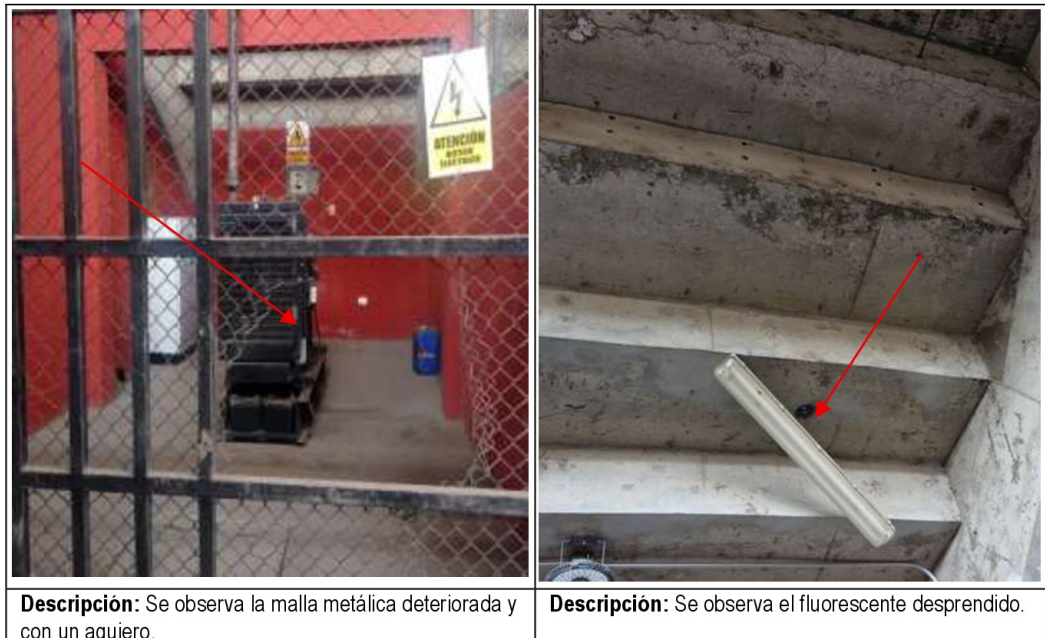
Fotografías n.ºs 39 y 40 Instalaciones Eléctricas
