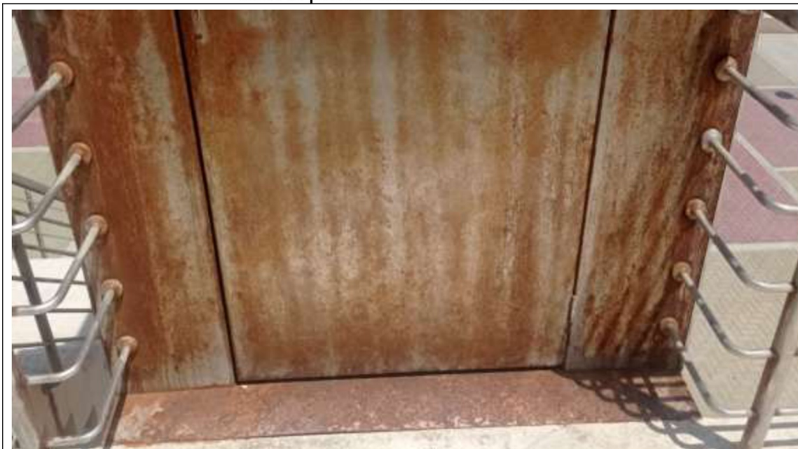
Fotografía n.º 9 Oxido en planchas de acero de Elevador
