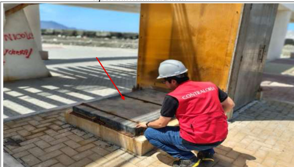
Fotografía n.º 16 Caja de Motor reductor del Elevador
