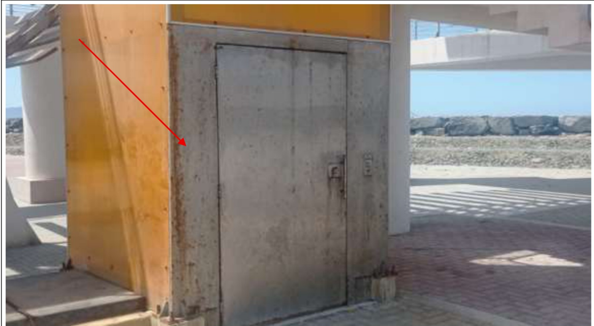
Fotografía n.º 6 Oxido en planchas de acero de Elevador
