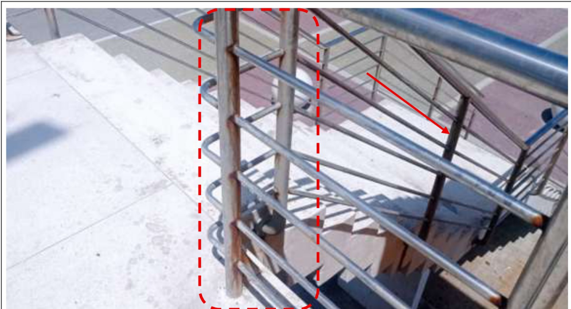
Fotografía n.º 5 Oxido en soldadura de Barandas de Acero en Escaleras
