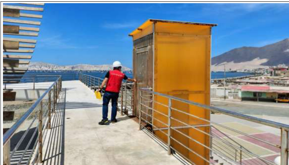
Fotografía n.º 15 Elevador fuera de funcionamiento
