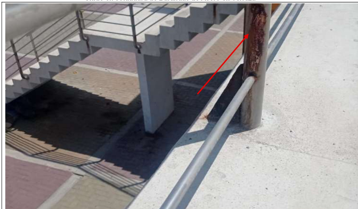
Fotografía n.º 3 Oxido en soldadura de Barandas de Acero en Terraza
