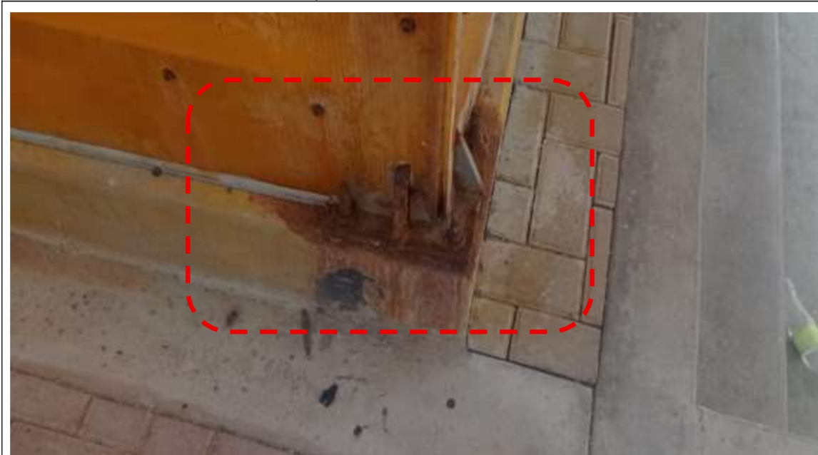
Fotografía n.º 7 Oxido en planchas de acero de Elevador
