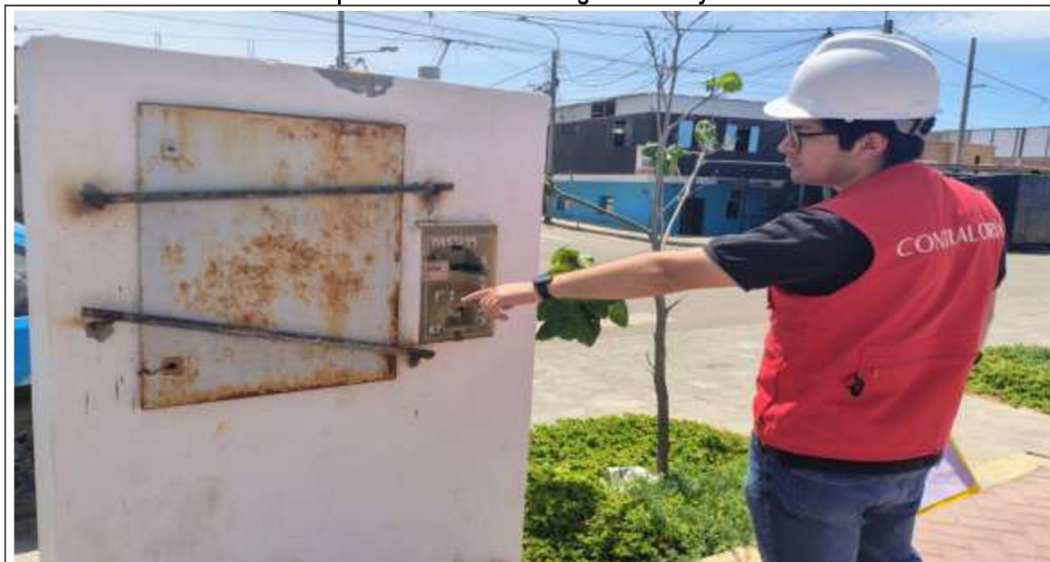
Fotografía n.º 17 Tablero Principal de Suministro de energía Eléctrica y medidor
