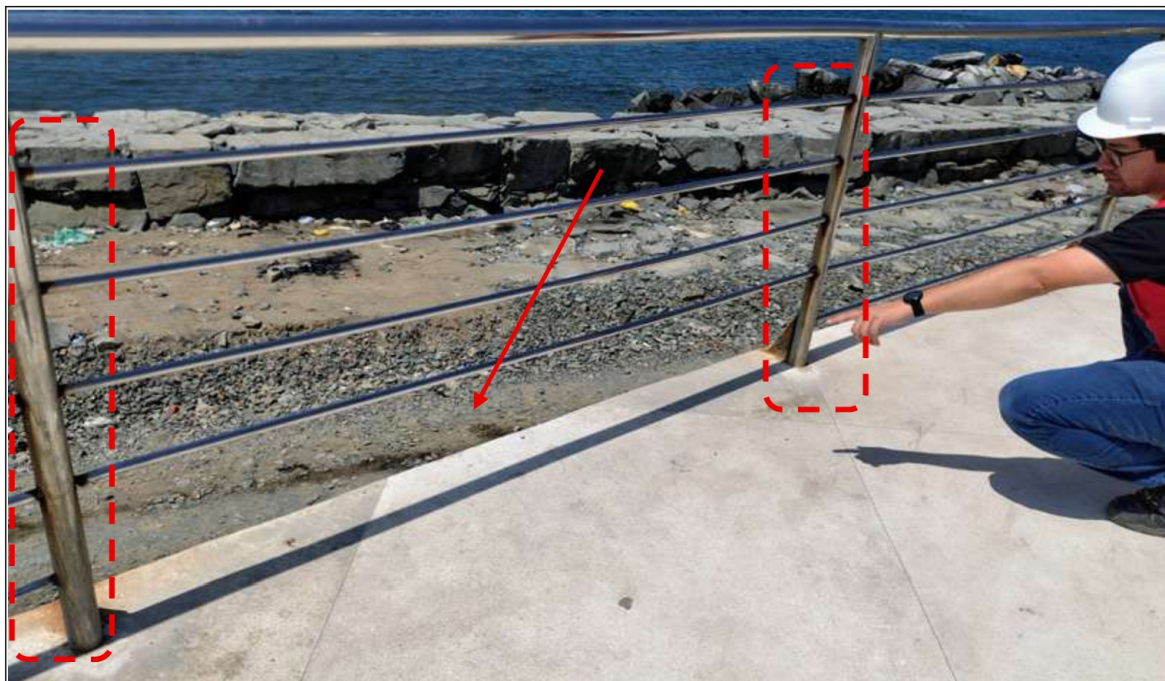
Fotografía n.º 2 Oxido en soldadura de Barandas de Acero en Terraza
