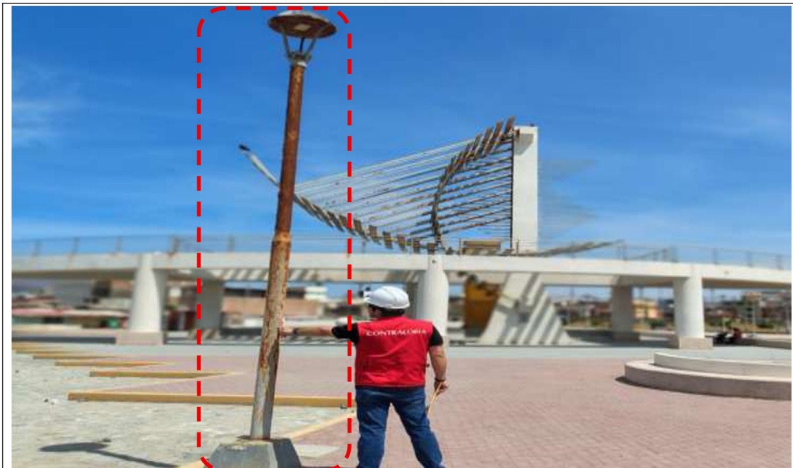
Fotografía n.º 11 Oxido en Postes Ornamentales
