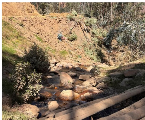
Fotografía N° 2 Inexistencia de limpieza y descolmatación
