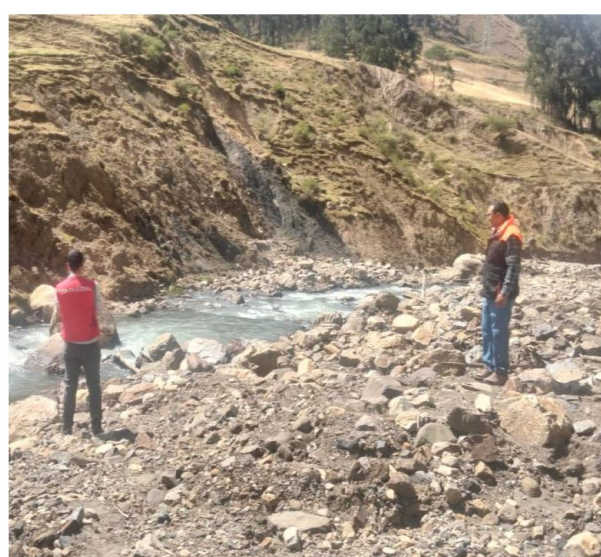
Fotografía N° 4 Inexistencia de diques
