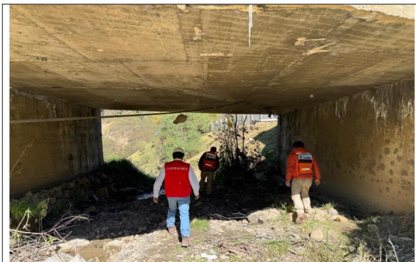
Foto N°02: Verificación del estado actual en la quebrada Acoshewa sector Santa Rosa- Independencia.
