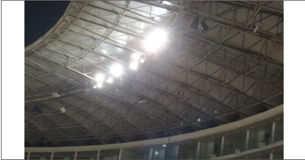
Imagen n.º 16 Luminarias encendidas en los tijerales del techo del Estadio Nacional
