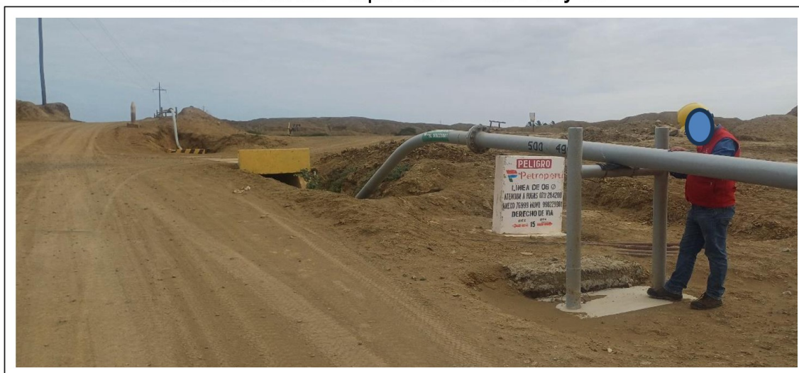
Fotografía n.º 13 Oleoducto Overales – soporte de los tramos 499 y 500
