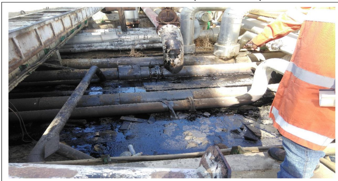
Fotografía n.º 2 Refinería de Talara - Zona de Racks Principal con falta de limpieza
