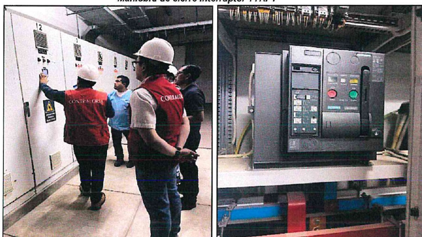
Imágenes n.°s 12 y 13 Maniobra de cierre interruptor TTRF1
