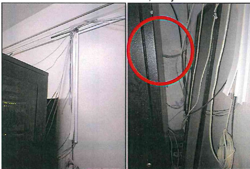
Imagen n.º 28 Cableado instalado en zonas con humedad, moho y deterioro estructural
