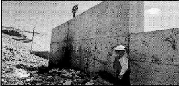
FOTOGRAFÍA N° 31 VERIFICACION DE MURO DE H=11.30 RELLENADO SOLO HASTA MITAD DE SU ALTURA
