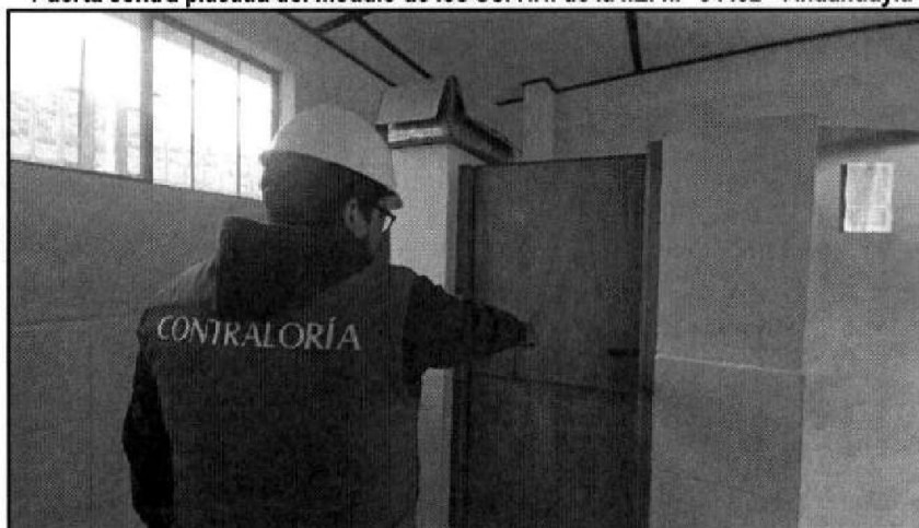
Fotografía n.º 32 Puerta contra placada del módulo de los SS. HH. de la I.E. n.º 34482 - Andahuayla
