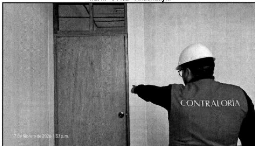
Fotografía n.º 30 Puerta contra placada del ambiente de almacén de la cocina del módulo I de la I.E. n.º 34482 - Andahuayla
