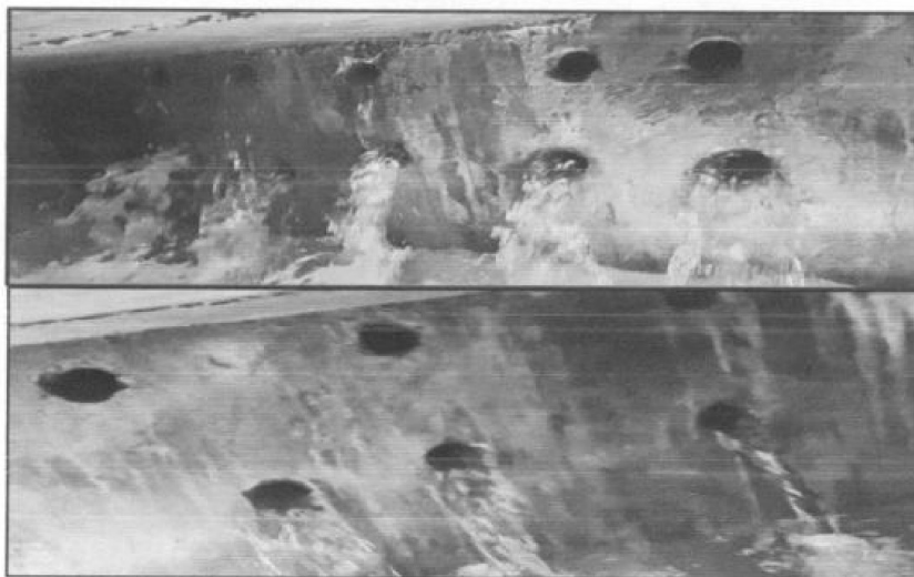
Fuente: Acta de Inspección física n.° 001-2025-OCI/MPHi-RI de 03 de junio de 2025.
