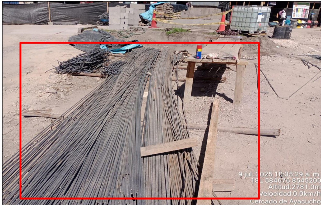
Imagen n.º 3 El acero expuesto sin protección y en contacto directo con el suelo
