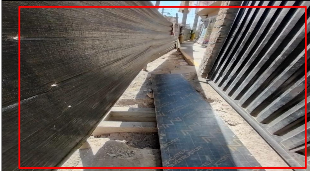
Imagen n.º 6 Zona lateral de la obra sin señalización de seguridad que garantice la seguridad de ciudadanos.
