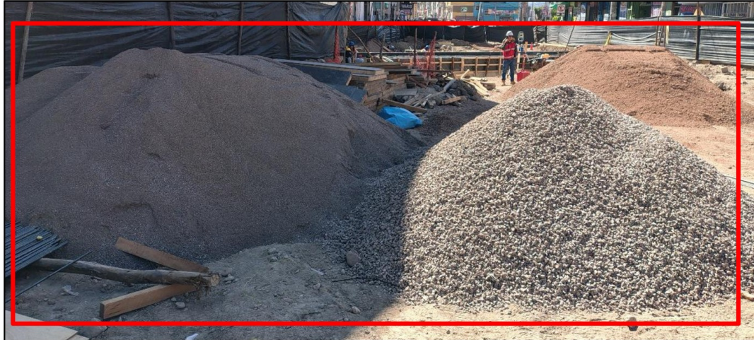
Imagen n.º 2 Arena gruesa y piedra chancada en contacto directo con el suelo y sin protección
