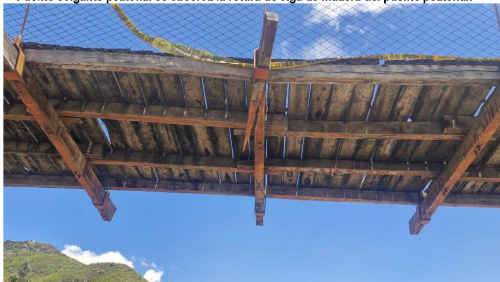
Imagen n° 41 Puente colgante peatonal se observa la rotura de viga de madera del puente peatonal.
