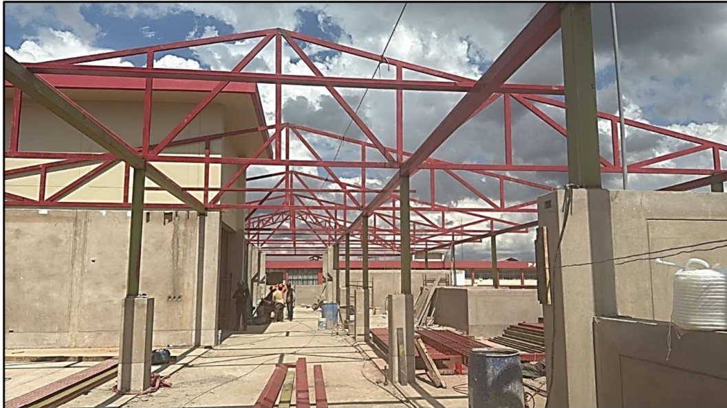
Imagen n.° 6 Ejecución de Servicio en tercer nivel sin aprobación de la autoridad competente
