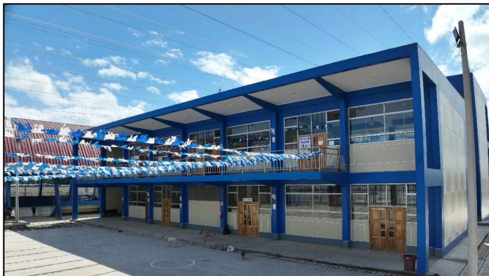
Imagen n.º 9 Bloque 3 no cuenta con SS. HH.
