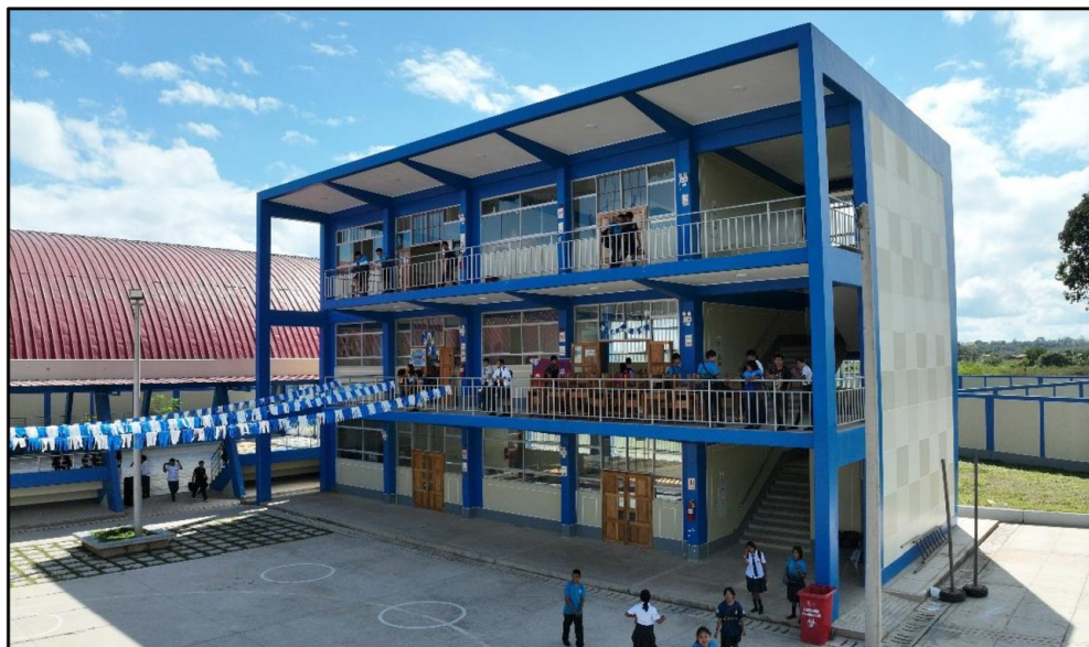
Imagen n.º 11 Bloque 6 no cuenta con SS. HH.
