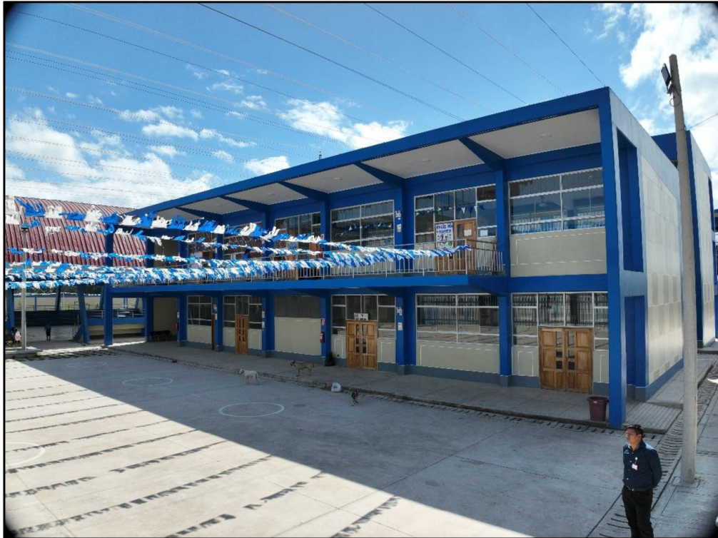
Imagen n.º 5 Bloque n.º 3 no cuenta con rampas ni ascensor
