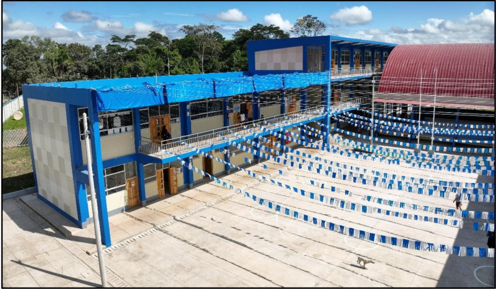
Imagen n.º 4 Bloques 1 y 2 no cuenta con rampas ni ascensor
