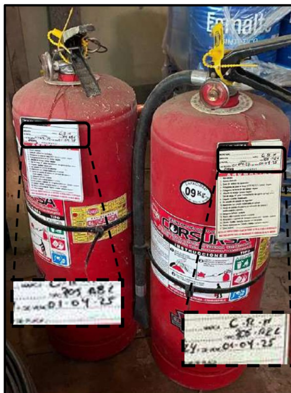
Imagen n.° 14 Extintores de polvo químico seco x 9 kg con fecha de recarga vencida ubicado dentro del Almacén de la obra
