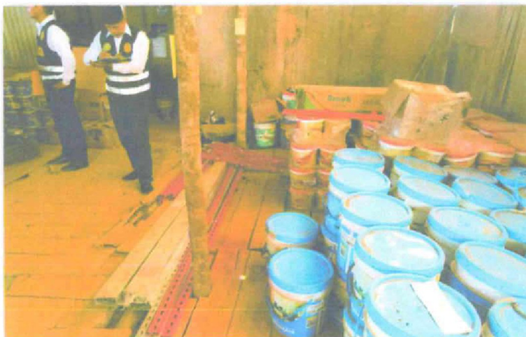
IMAGEN 24. VISTA DE CONSTATAción POLICIAL REALIZADA EN OBRA DEBIDO A LOS MATERIALES FALTANTES EN OBRA.
