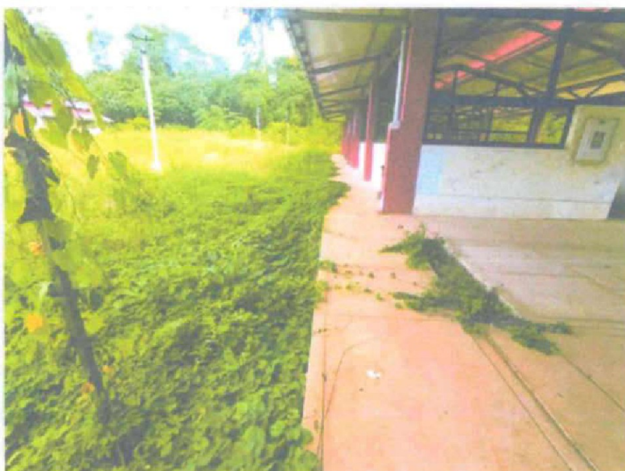
IMAGEN 10. VISTA DE CANALES PLUVIALES CON VEGETACIÓN EN LA ZONA 02.
