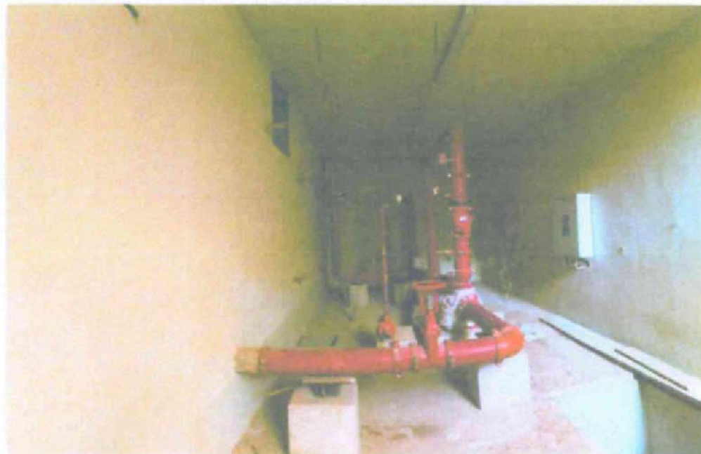
IMAGEN 11. VISTA CASETA DE MAQUINAS DEL SISTEMA CONTRA INCENDIO Y EL TABLERO GENERAL DE CASETA DE MAQUINAS.
