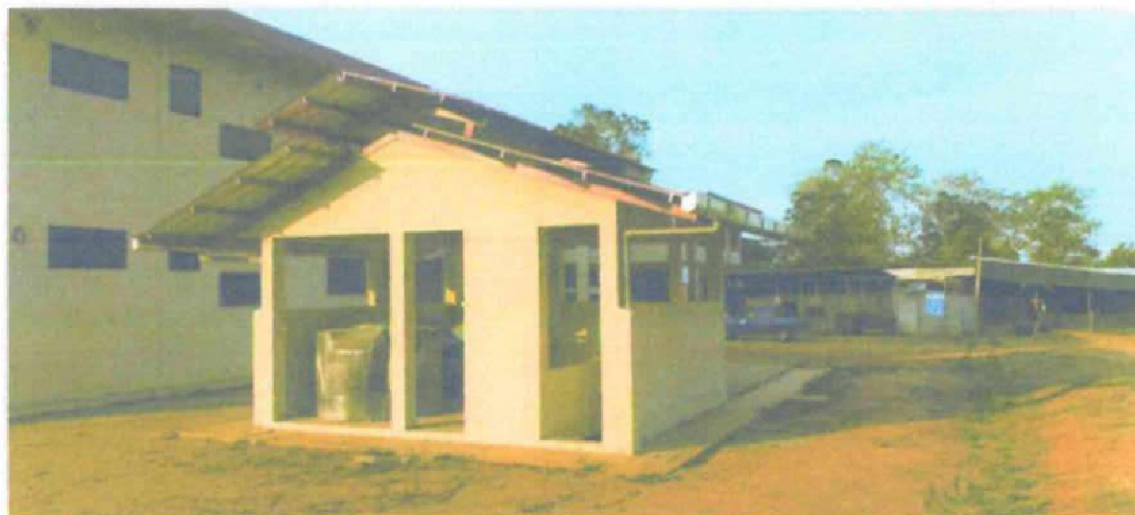
IMAGEN 09. VISTA PANORÁMICA DE CASETA DE TRATAMIENTO DE AGUA EN LA ZONA 01.
