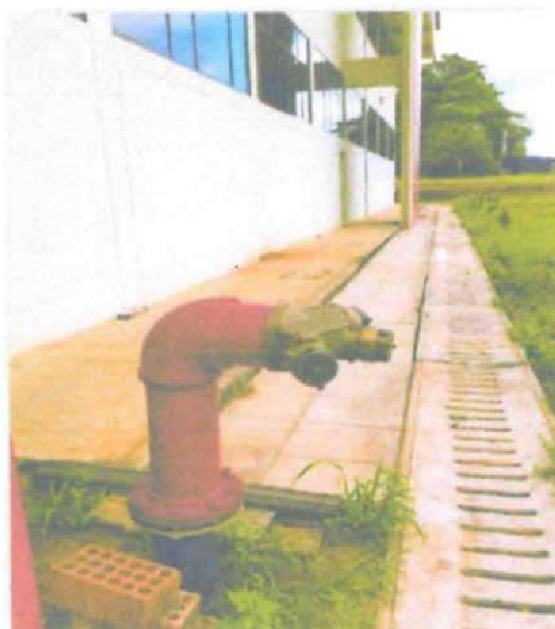
IMAGEN 14. SE HA ENCONTRADO LA INSTALACIÓN DE TUBERÍA DE ACERO DE 6", CODO DE 6" Y CABEZAL DE BRONCE DE SIAMESA CON TRES SALIDAS DE 2 1/2" EN EL BLOQUE 01.
