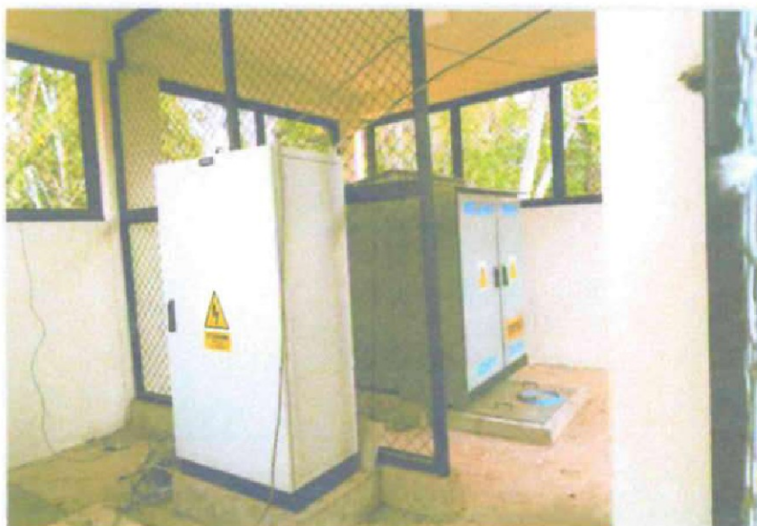
IMAGEN 08. VISTA DEL TABLERO GENERAL Y TRANSFORMADOR DE 250KVA, EN LA CASETA DE FUERZA.
