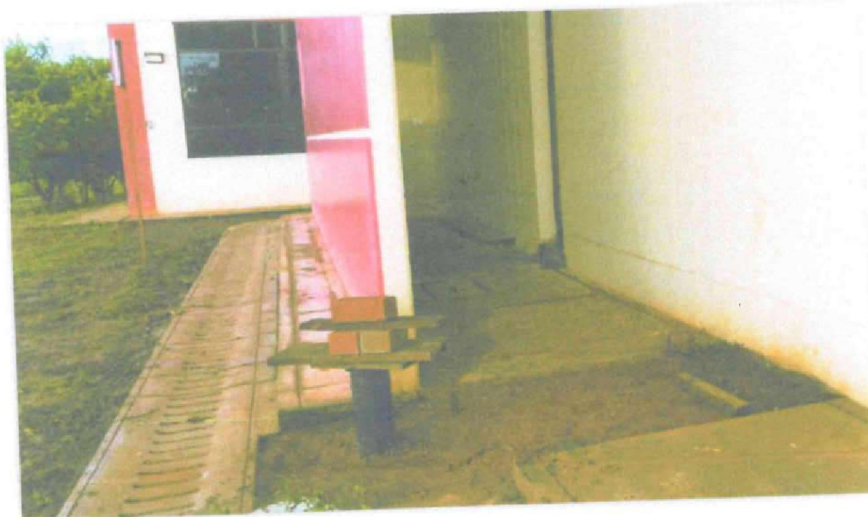
IMAGEN 14. SALIDA DE TUBO HDPE DE 6" PARA INSTALACIÓN DE SIAMESA INCOMPLETA EN EL BLOQUE 01.
