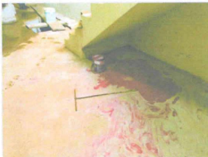
IMAGEN 15. SE HA ENCONTRADO EL PISO DE LA CASETA DE MAQUINAS MANCHADAS DE PINTURA.
