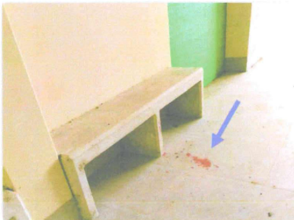
IMAGEN 17. SE ENCONTRARON PINTADOS LOS PISOS EN EL SEGUNDO NIVEL DEL BLOQUE 01
