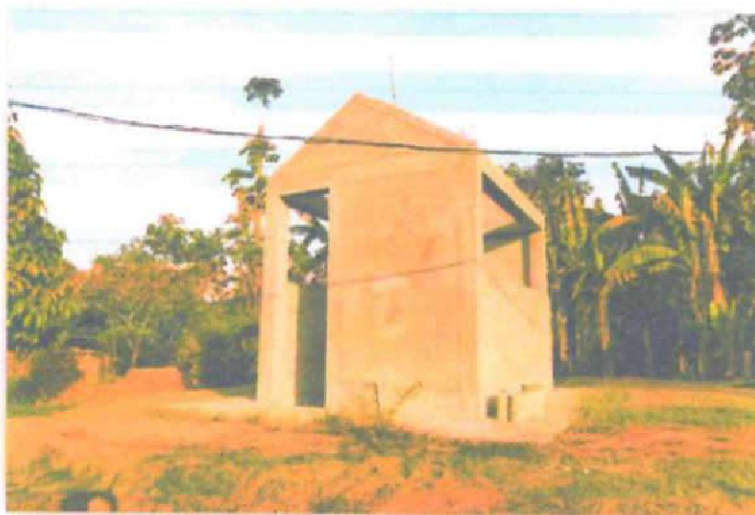
IMAGEN 18. VISTA PANORÁMICA DE CASETA DE POZO TUBULAR EN LA ZONA 01.
