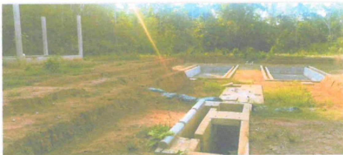
IMAGEN 41. VISTA PANORÁMICA DE LA PLANTA DE TRATAMIENTO DE AGUAS RESIDUALES EN LA ZONA 02.
