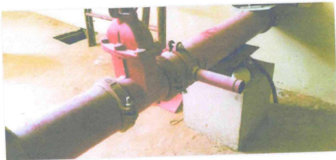
IMAGEN 13. VISTA DE VALVULA OS&Y RANURADO Y SALIDA DE TUBERIA INCOMPLETA HACIA BOMBA JOCKEY EN LA CASETA DE MAQUINAS DE LA ZONA 01.
