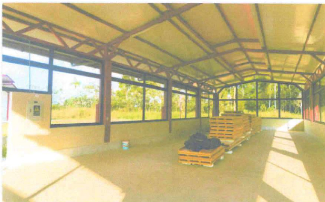
IMAGEN 31. VISTA PANORÁMICA INTERNA DE MÓDULO DE CRIANZA DE AVES DE LA ZONA 02.
