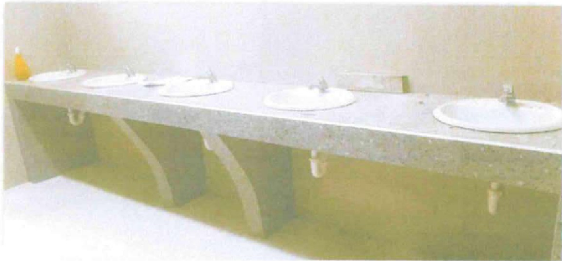
IMAGEN 05. VISTA DE MESA Y OVALINES CON GRIFOS INSTALADOS EN LA ZONA 01.
