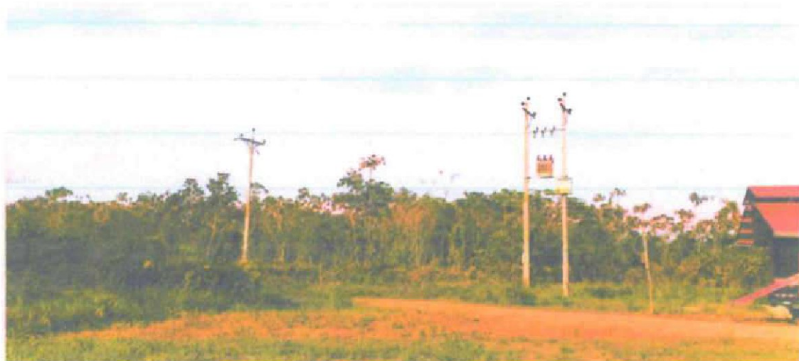
IMAGEN 20. VISTA PANORÁMICA DE TRANSFORMADOR DE 100 KVA, AÉREO Y TABLERO GENERAL EN LA ZONA 02.
