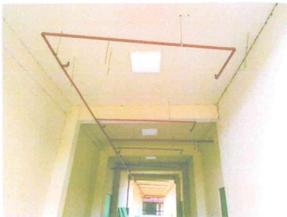
IMAGEN 20. SE EVIDENCIA QUE LAS TUBERIAS DE LA RED CONTRA INCENDIO SE ENCUENTRAN PINTADAS EN EL SEGUNDO NIVEL DE LA ZONA 01.
