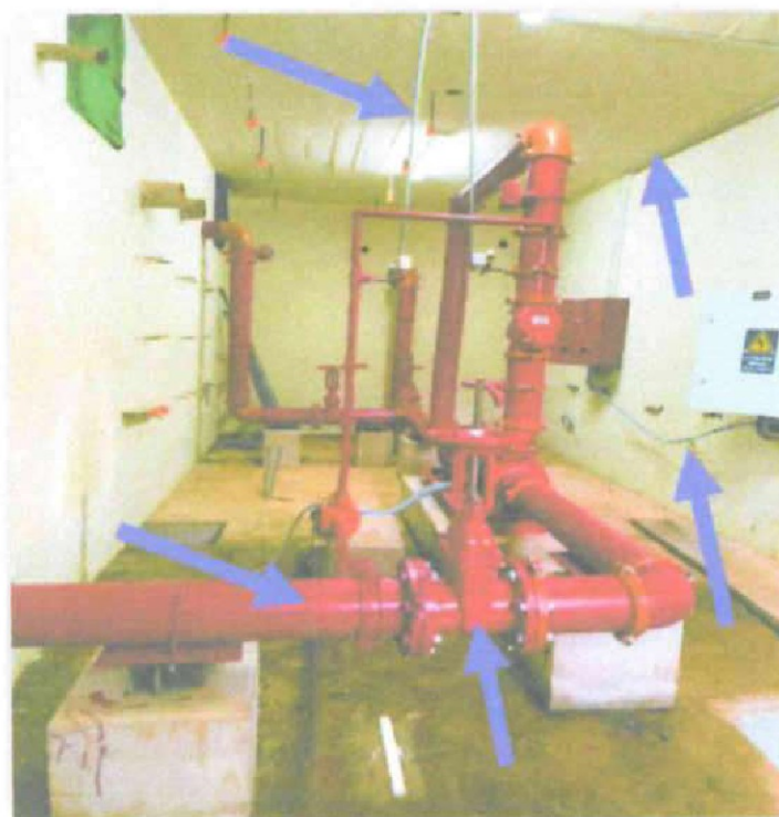
IMAGEN 16. SE HAN ENCONTRADO PINTADOS EL SISTEMA CONTRA INCENDIO EN LA CASETA DE MAQUINAS, ADEMÁS DE INSTALACIONES ELÉCTRICAS E INSTALACIÓN DE DUCTOS CONDUIT CORRUGADO DE 2" Y CONDUIT DE 6" Gº, DE 3/4", ADEMÁS DE VALVULA OS&Y BRIDADA DE 6"
