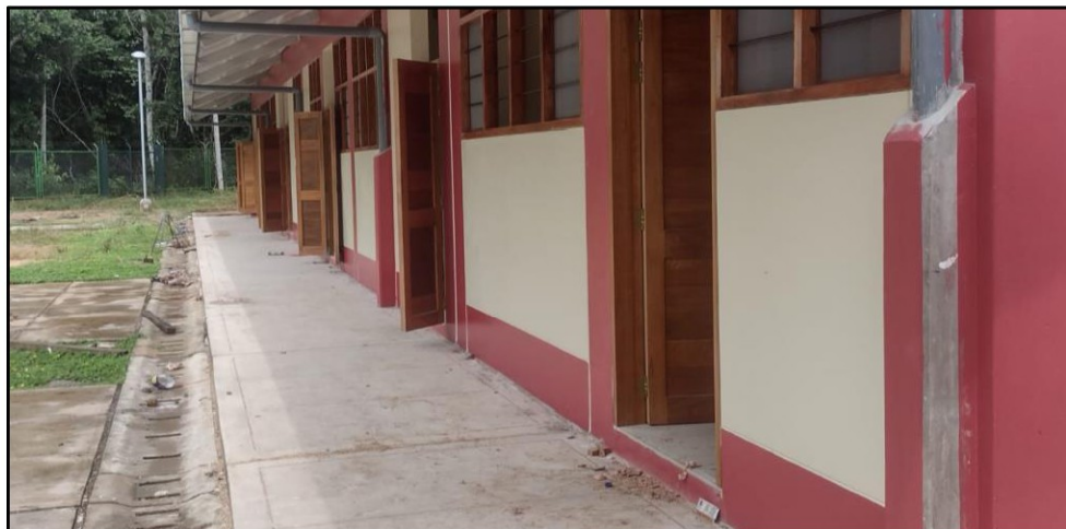
Imagen n.º 2 Desnivel entre la vereda y el piso terminado del Bloque de Investigación de la Obra
