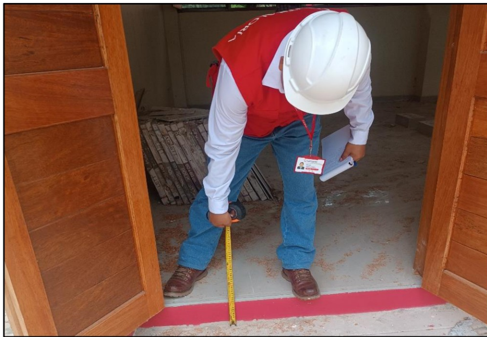
Imagen n.º 1 Trece (13) centímetros de desnivel entre la vereda y el piso terminado
