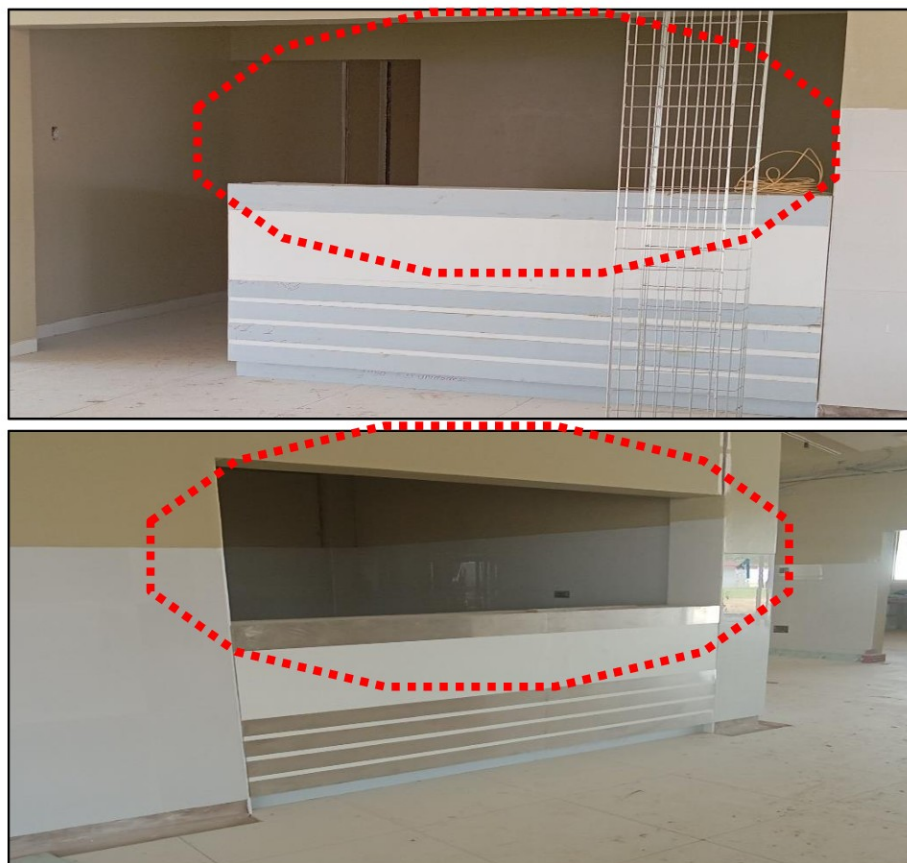
Imagen n.º 2 Vista del estado actual del mueble sin culminar al 100% al no contar con cerramiento y acabados de vidrio para las ventanillas de atención
