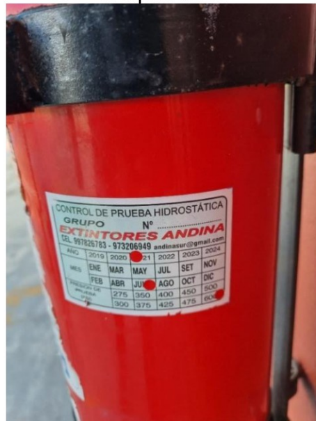
Imagen n.º 69 Extintor n.º 1 vencido desde el 2021 ubicado en el patio central
