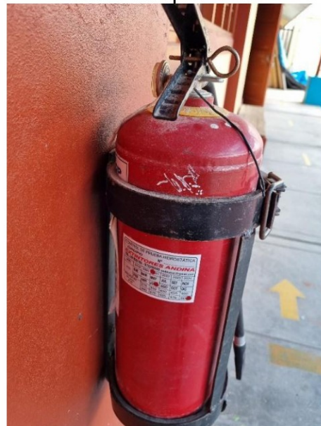
Imagen n.º 70 Extintor n.º 2 vencido desde el 2021 ubicado en el patio central
