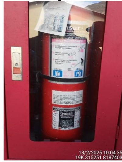
Imagen n.º 66 Extintor sin vigencia toma n.º 2
