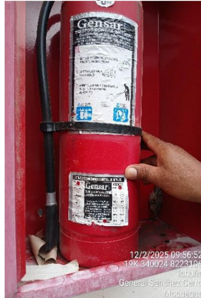
Imagen n.º 63 Extintor sin vigencia toma n.º 1
