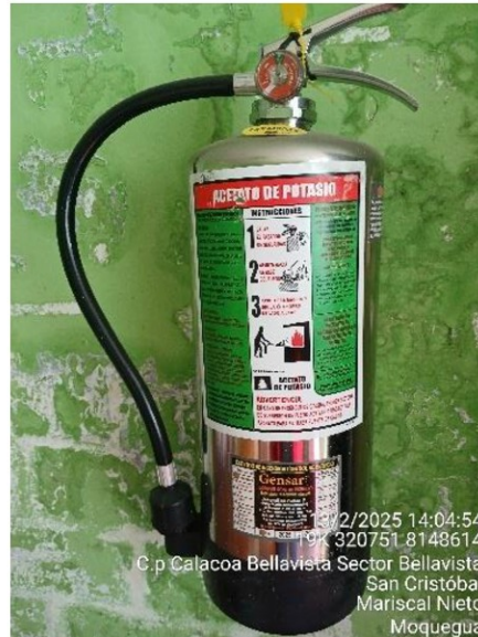
Imagen n.º 67 Extintor sin vigencia toma n.º 1
