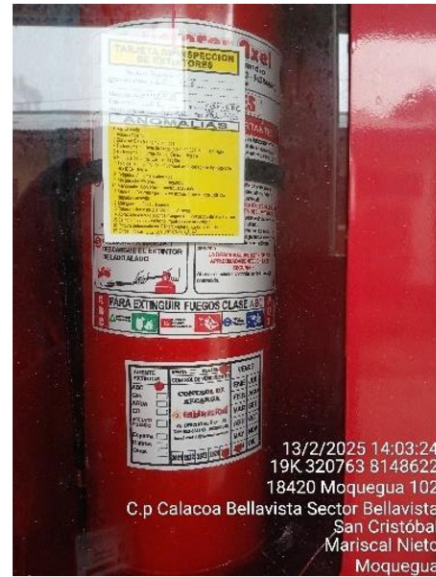
Imagen n.º 68 Extintor sin vigencia toma n.º 2
