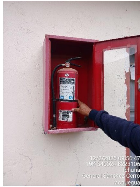
Imagen n.º 64 Extintor sin vigencia toma n.º 2
