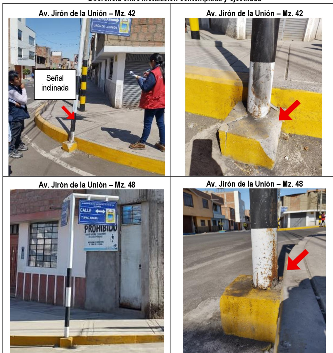
Panel fotográfico n.º 10 Diferencia entre instalación contemplada y ejecutada
