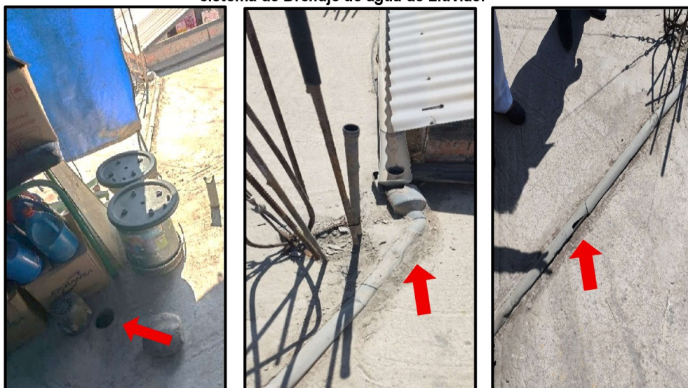
Imagen n.ºs 10, 11 y 12 Punto de evacuación sin rejilla, deformación y rotura de tubería PVC del sistema de Drenaje de agua de Lluvias.
