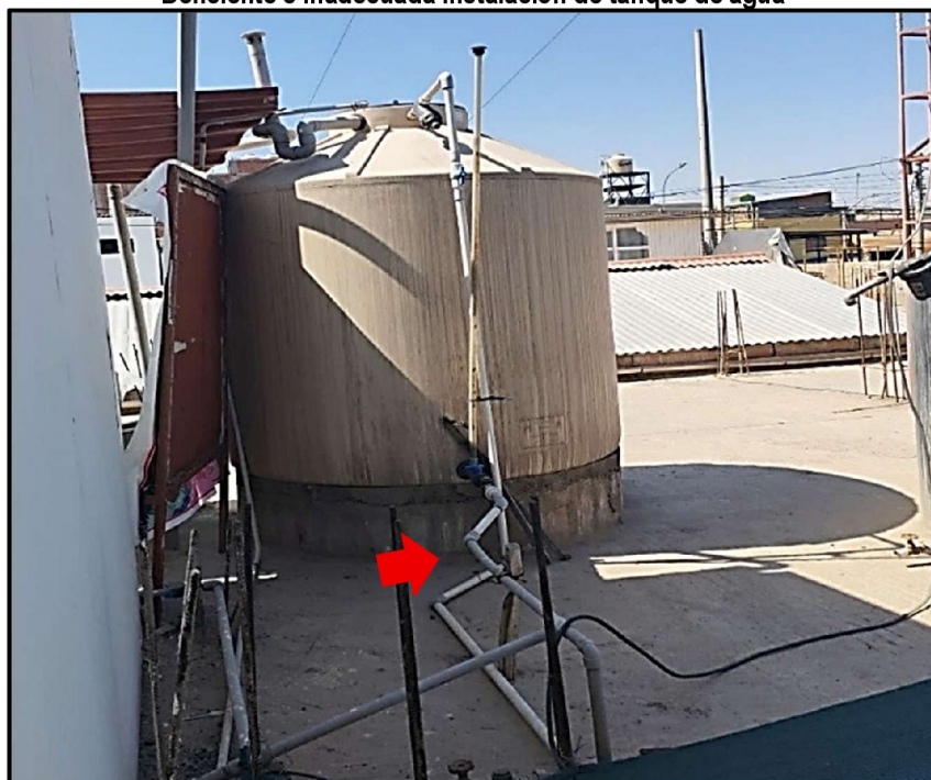
Imagen n.º 26 Deficiente e inadecuada instalación de tanque de agua
