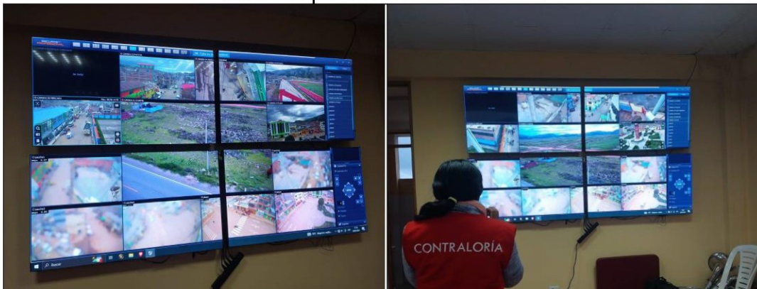
Verificación de las cinco (5) cámaras de videovigilancia inoperativas
