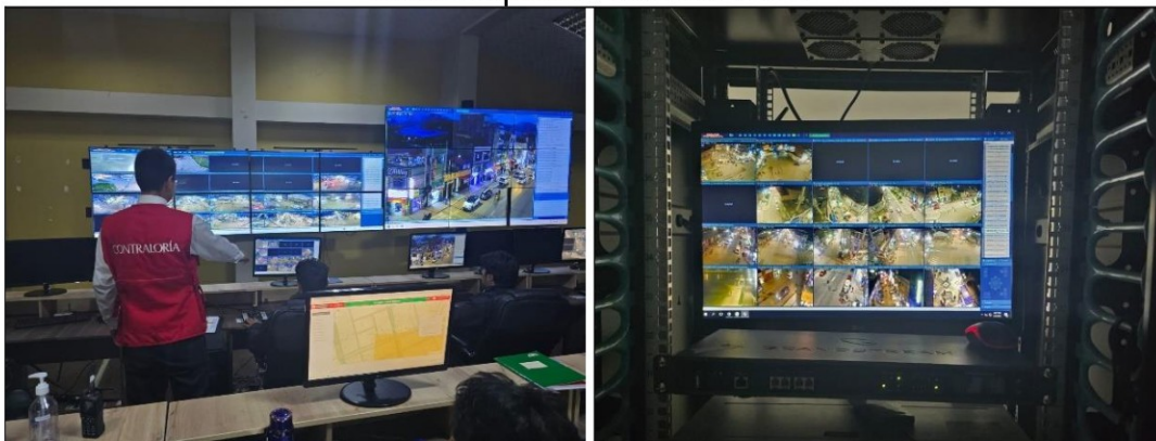
Verificación de las diecisiete (17) cámaras de videovigilancia inoperativas
