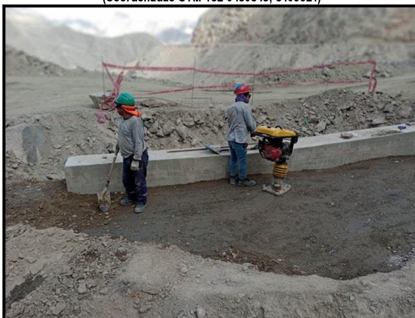
Fuente: Imagen n.° 19 de Acta de inspección física n.°01-2025-CG/GRIC-SCC-PETACC Elaborado por: Comisión de Control
