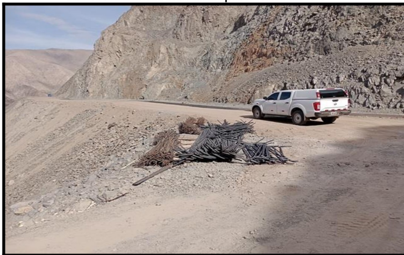
Imagen n.º 16 Acero de Refuerzo acumulado presenta oxidación.
