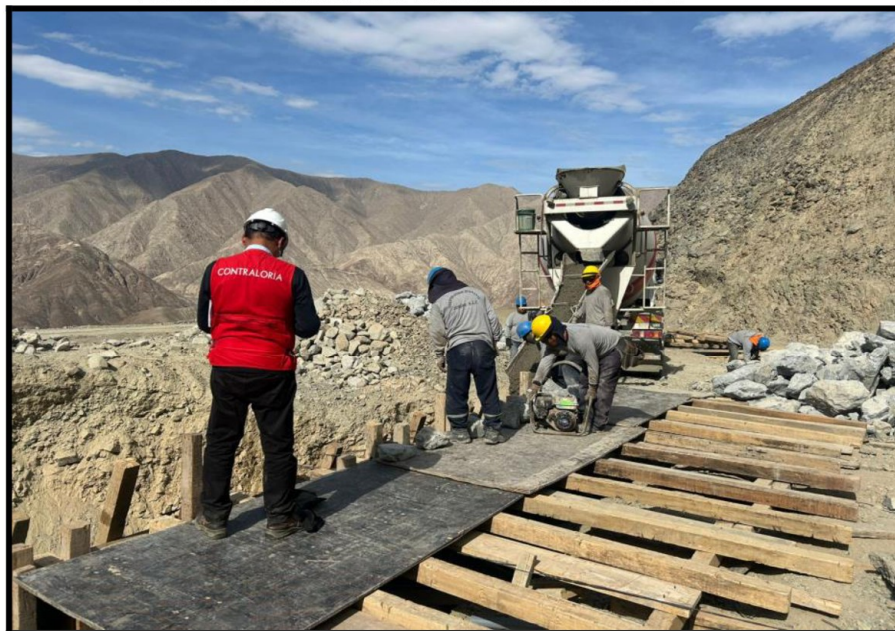
Fuente: Imagen n.°6 de Acta de Inspección física n.°01-2025-CG/GRIC-SCC-PETACC Elaborado por: Comisión de Control
