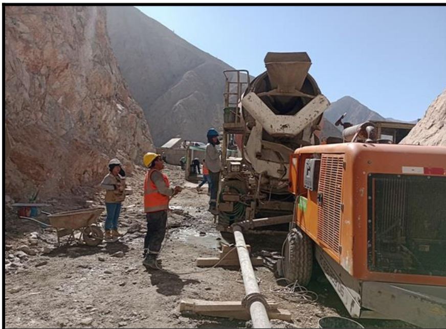
Fuente: Imagen n.º30 de Acta de inspección física n.º01-2025-CG/GRIC-SCC-PETACC de 27 de junio de 2025 Elaborado por: Comisión de Control
