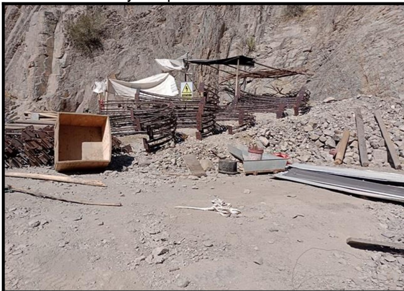
Imagen n.º18 Cimbras de Acero Corrugado ASTM 706 Grado 60 que están instalando en el Túnel n.º2, están apoyadas directamente sobre suelo natural y sin la protección adecuada
