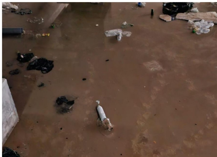
Fotografía n.º10.- Se visualiza restos de desechos plásticos y charco de agua en zona de ascensor.
