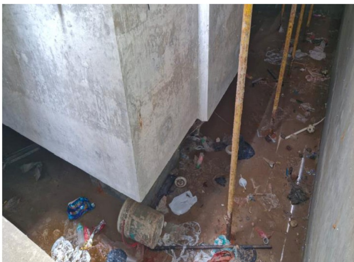
Fotografía n.º11.- Se visualiza restos de desechos plásticos y charco de agua en zona de ascensor.
