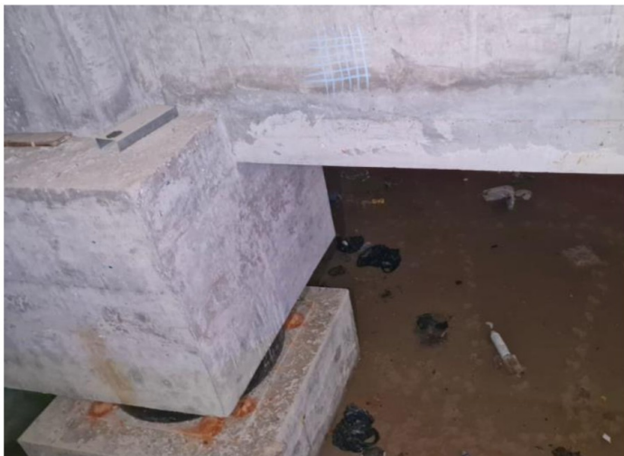
Fotografía n.º7.- Se visualiza zona de ascensor con presencia de charcos de agua; así también, pedestal de aislador con presencia de humedad.
