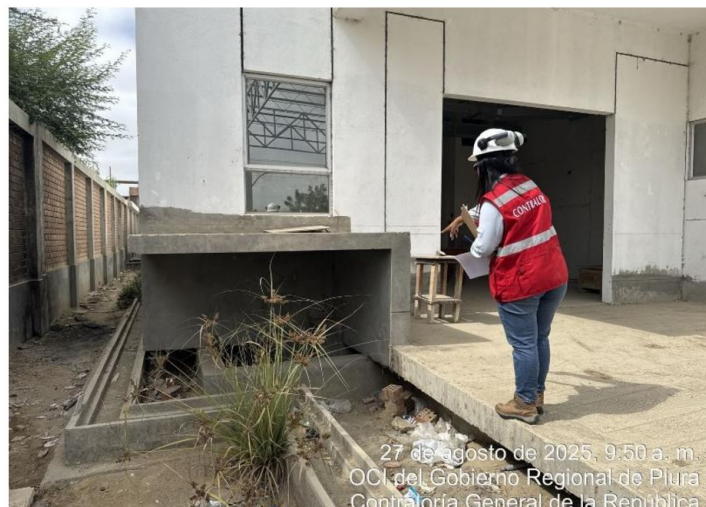
Fotografía n.º2.- Se visualiza el acceso hacia los aisladores sísmicos – Área de piso técnico.
