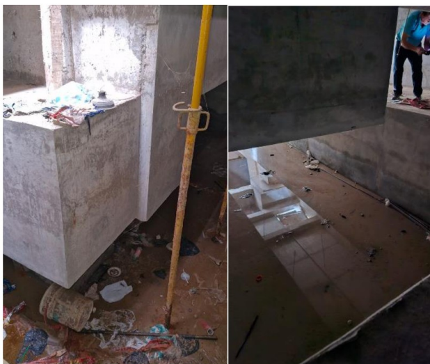
Fotografía n.º9.- Se visualiza restos de desechos plásticos y charco de agua en zona de ascensor.
