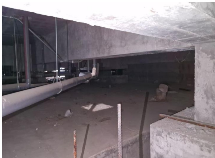
Fotografía n.º3.- Se visualiza cimentación y pedestales de aisladores, sin presencia de humedad – Área de piso técnico.
