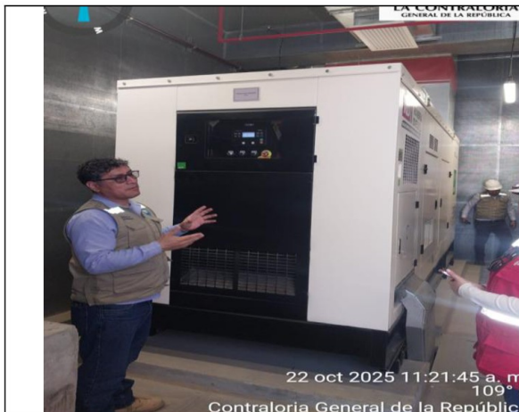
Imagen 6: Grupo electrógeno N°1 Inoperativo
