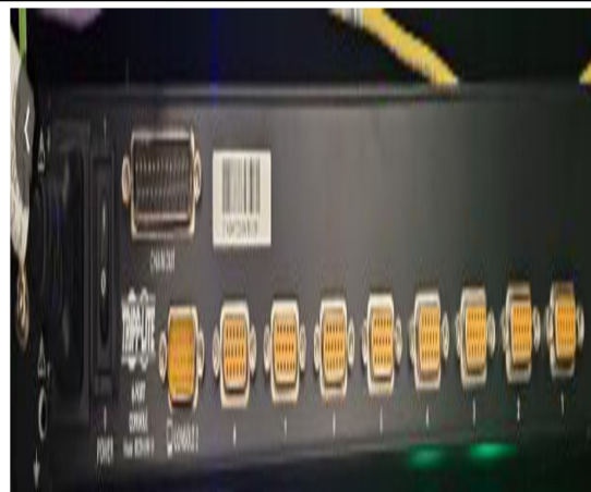
Imagen 7: El KVM Switch modelo B020-U08-19 ubicado en el data center no cuenta con puerto de red para la conexión a la configuración total de la data center, no se visualiza un uso operativo de dicho equipo
