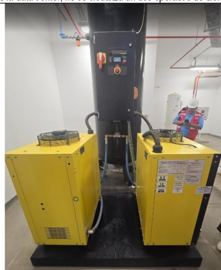
Imagen 9: El generador de oxígeno presenta filtración de aceite por falta de mantenimiento
