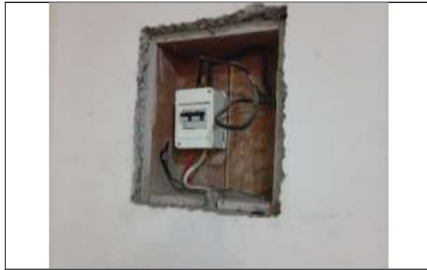
Imagen n.º52 Tablero eléctrico de rayos X
