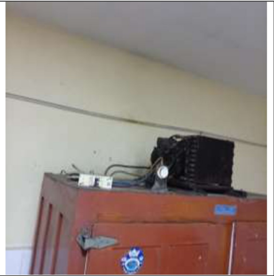
Interruptor termomagnético sin fijación encima de refrigeradora
