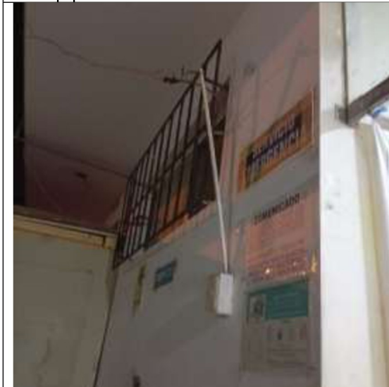
Cableado para interruptos simple deteriorado y expuesto
