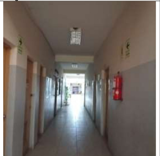
Luminarias inoperativos en pasillo administrativo.
