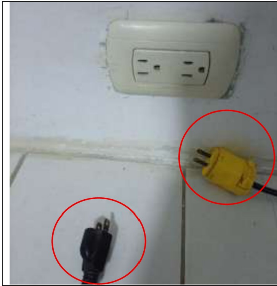
Enchufes sin el pin de protección de puesta a tierra del equipo.
