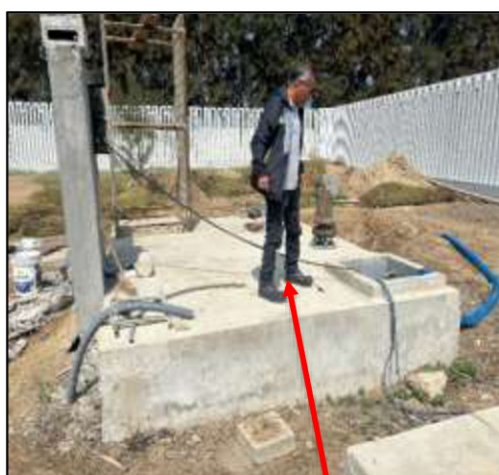
Cámaras de filtración que discurre a la red pública
