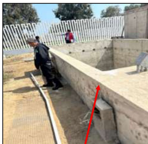
PTAR inconcluso y sin funcionamiento
