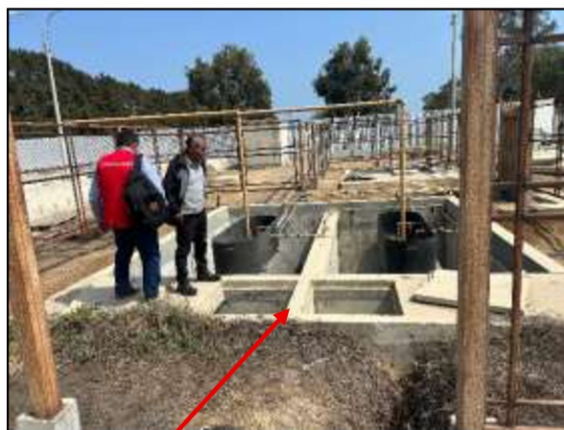
Infraestructura del sistema de GLP, inconcluso y sin uso
