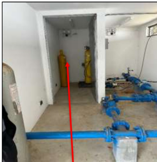
Balones de cloro gas sin funcionamiento
