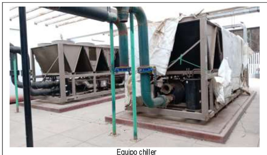
Imagen n.º 11 Equipo Chiller
