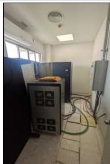
Sala de Energía
