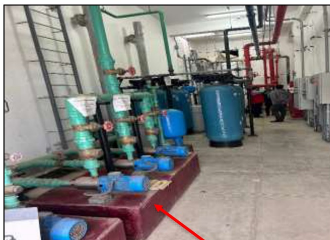
Tanques cisterna de almacenamiento para aguas blandas y duras sin desinfección
